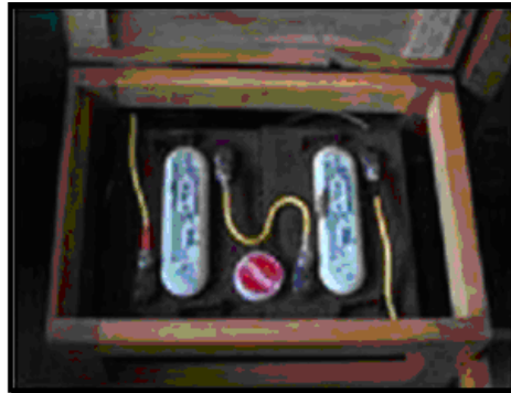
Figura 37: Banco de baterías.
