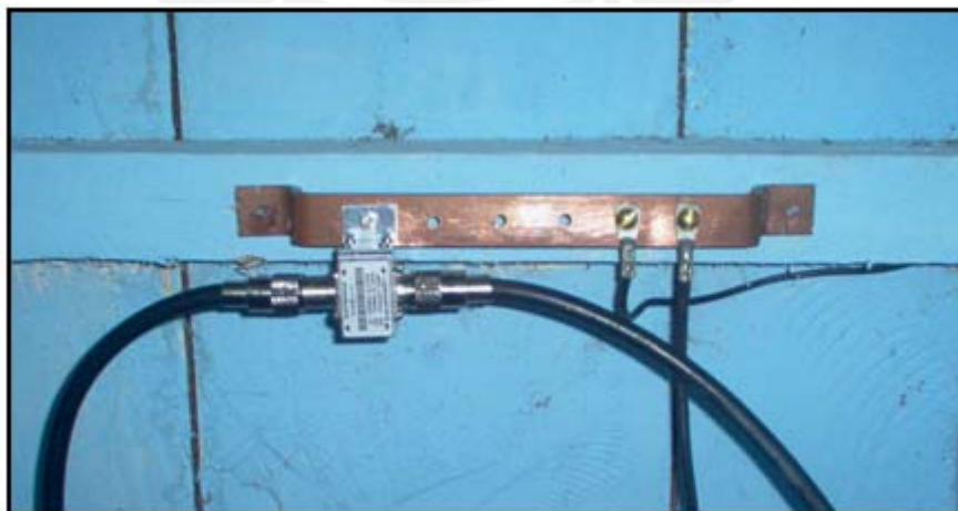
Figura 43: Protector de Línea instalado en barra master.
