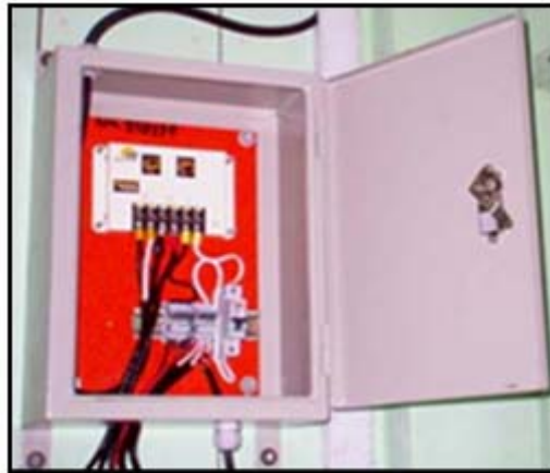
Figura 39: Caja de distribución con un regulador.
