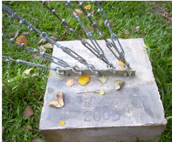
Figura 55: Ferretería de sujeción de vientos de la torre.
