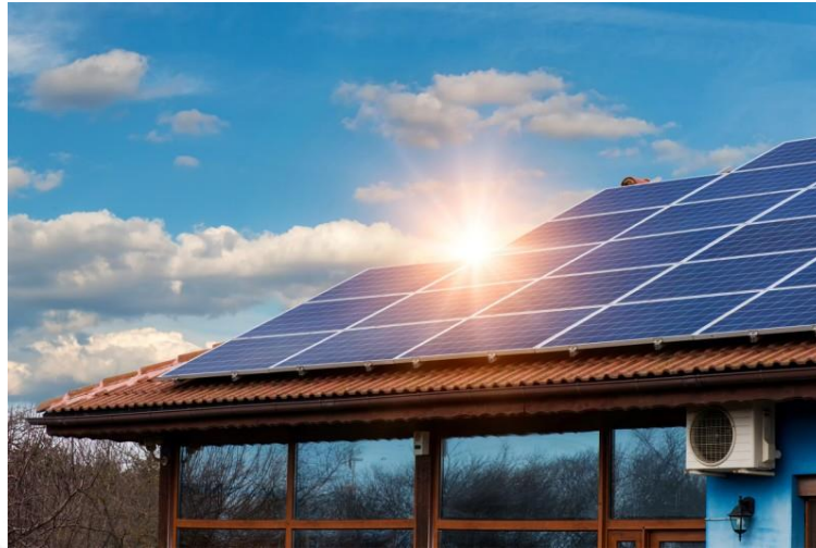
Figura 5: Paneles Solares Fotovoltaicos instalados en el techo de una vivienda.
