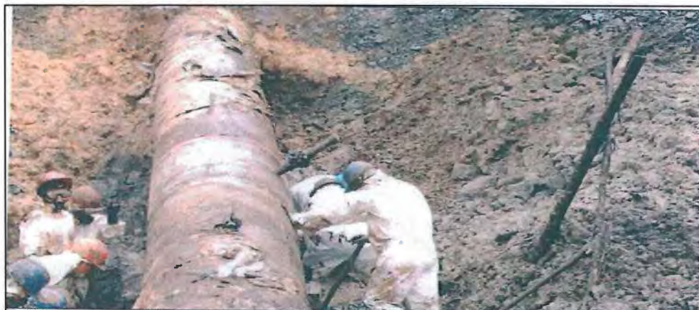
Foto 12: Vista cercana de zona de la tubería por donde fugaba el petróleo crudo, se observa una plancha metálica soldada a la tubería con un tapón y una válvula de 2\"
