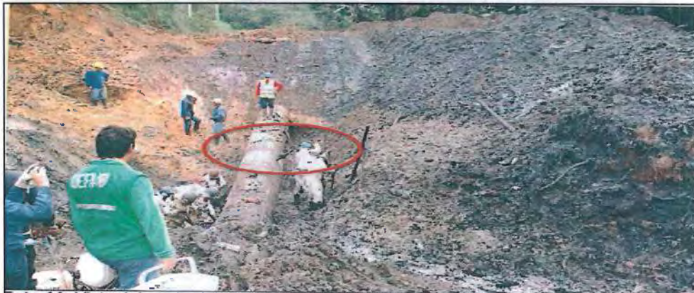
Foto 11: Vista del punto del derrame de petróleo crudo, se observa que el derrame ya fue controlado.
