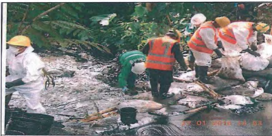
Foto 07: Muestra a personal por parte de la empresa PETROPERÚ instalando barreras de contención en el cauce de la quebrada Inayo, aguas abajo del punto del derrame.
