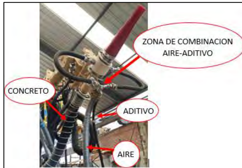
Figura N° 22 Manguera de aditivo.
