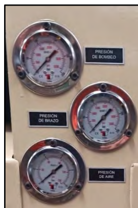
Figura N° 70 Manómetro de Presión de bombeo.
