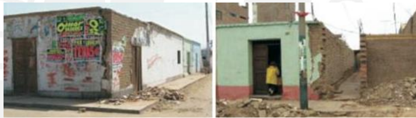
Figura 2.28 – Grietas verticales en los encuentros de muros, terremoto de Pisco 2007 (Blondet et al., 2011)
