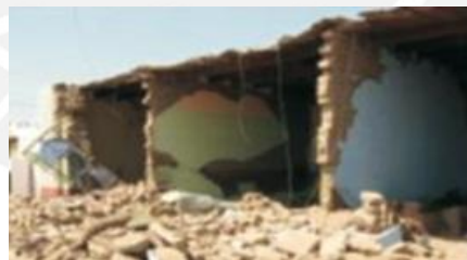
Figura 2.29 –Volteo de muro, terremoto de Pisco 2007 (Blondet et al., 2011)
