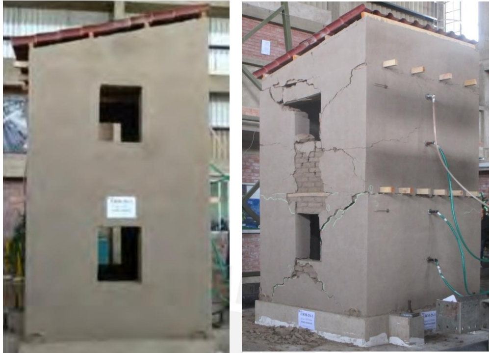
a) Módulo sin refuerzo previo al ensayo b) Módulo sin refuerzo luego del ensayo (D=37,5mm)
