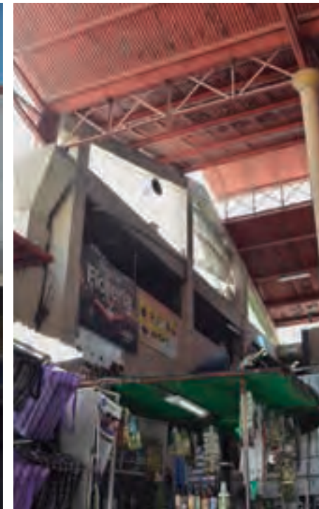
Quiebre entre edificaciones, la nueva edificación no resuelve su conexión con la edificación antigua y reemplaza elementos de metal por concreto
