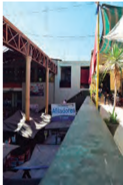
Separación entre el borde de concreto y techo metálico que provoca problemas de lluvias y asolamiento.
