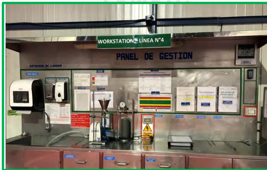
Figura 58: Estación de trabajo de la llenadora
