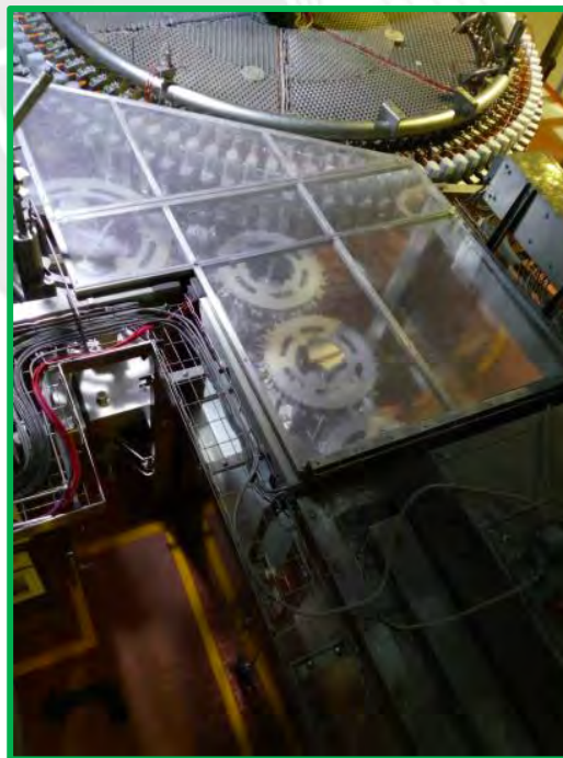
Figura 30: Mica instalada para reducción de fuentes de contaminación Fuente: Operación Autónoma LLEN6401 N1 (2020)
