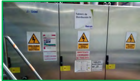
Figura 26: Identificación de Tableros Eléctricos
