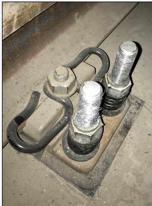
Fotografía: Sección de vía en placa con Vossloh 336 SD
