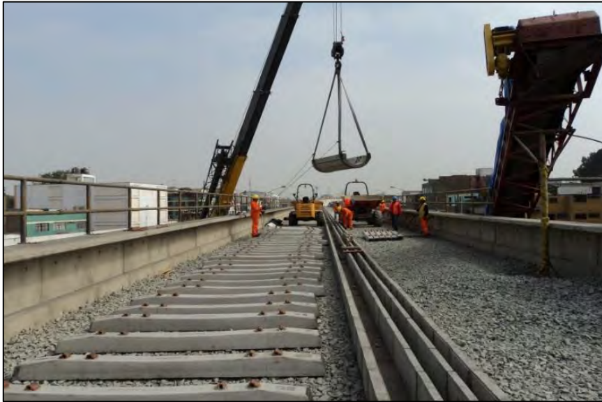
Fotografía: Izado de durmientes con eslinga (Viaducto Elevado) Fuente: Informe mensual de Supervisión
