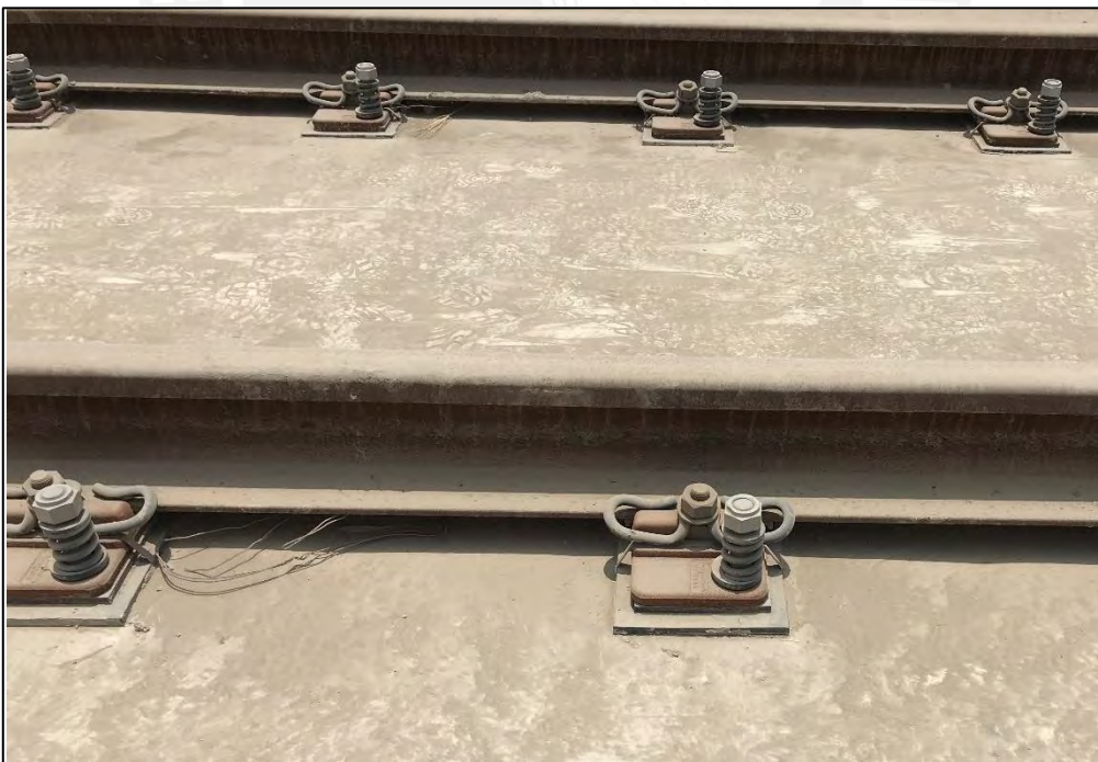
Fotografía: Sujeción Vossloh 336 Instalada Fuente: Fotografía Propia
