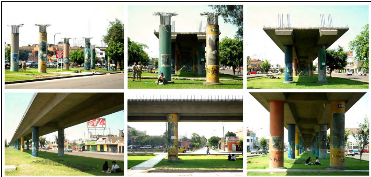
Figura: Infraestructura inconclusa abandonada en Av. Aviación, Suquillo
