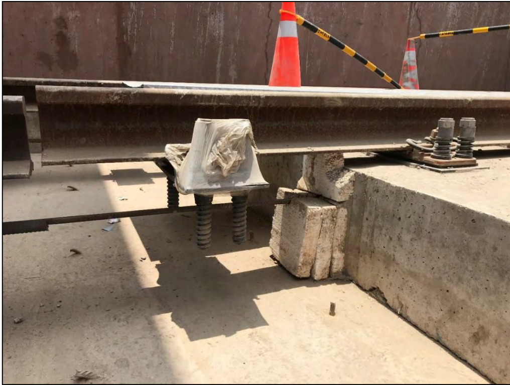
Fotografía: Sección de vía en placa con Vossloh 336 SD Fuente: Fotografía Propia
