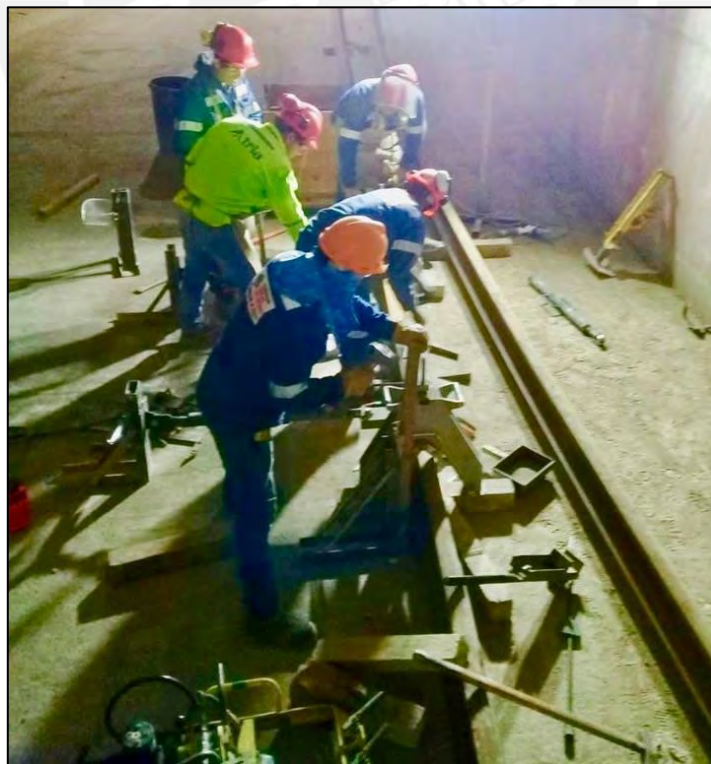
Fotografía: Equipo de trabajo soldadura aluminotérmica de riel Fuente: Metro de Lima y Callao - News
