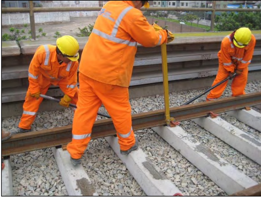
Fotografía: Colocación de Clip Pandrol con Panpuller (Viaducto elevado) Fuente: Informe mensual de Supervisión
