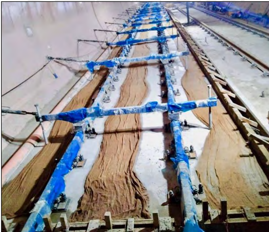
Fotografía: Curado de concreto con mantas de yute Fuente: Metro de Lima y Callao - News
