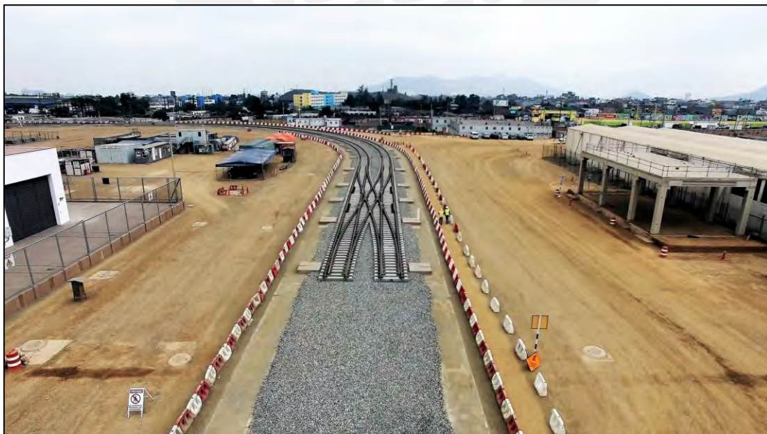
Fotografía: Vista aérea de desvío patio taller Fuente: Metro de Lima y Callao - News
