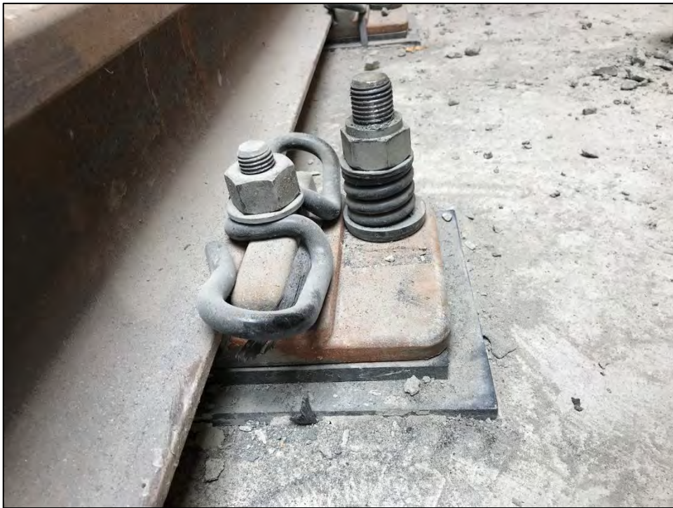
Fotografía: Sujeción Vossloh 336 con precinto provisional Fuente: Fotografía Propia
