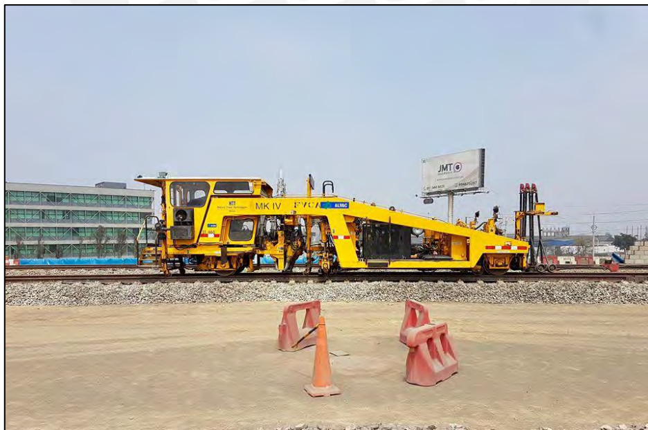
Fotografía: Bateadora de Balasto
