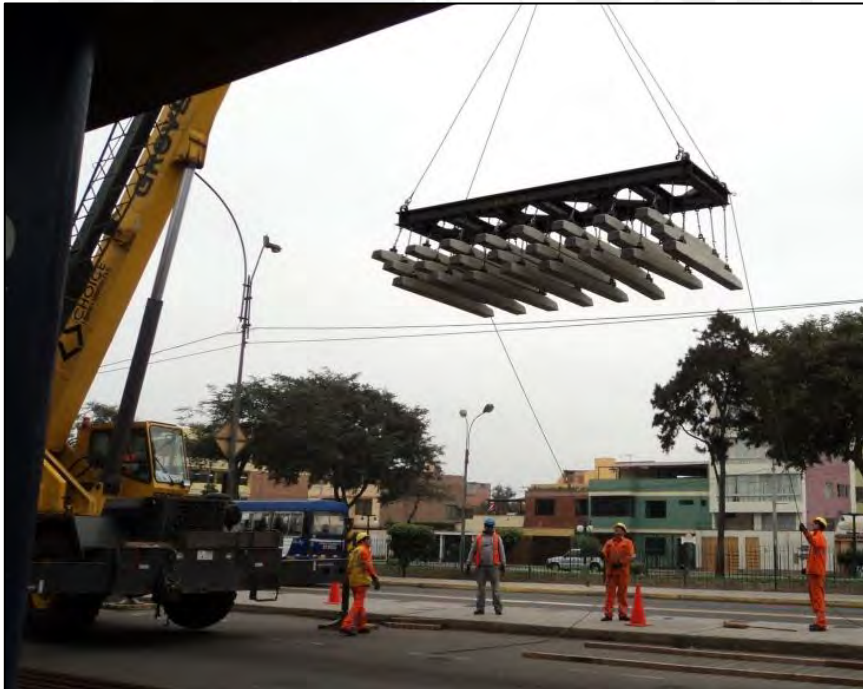
Fotografía: Izado de durmientes con portadurmientes (Viaducto Elevado) Fuente: Informe mensual de Supervisión
