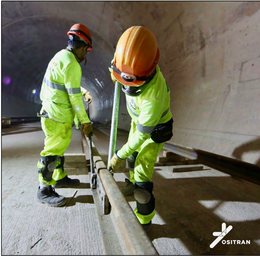
Fotografía: Instalación provisional de eclisas Fuente: Metro de Lima y Callao - News
