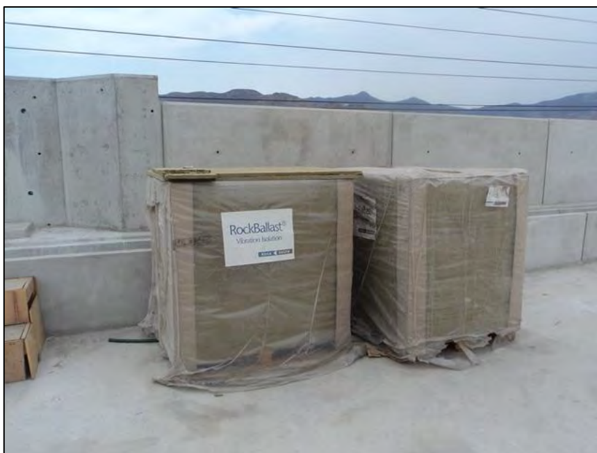
Fotografía: Sistema Antivibratorio Rock Ballast-Rock Delta Fuente: Informe mensual de Supervisión
