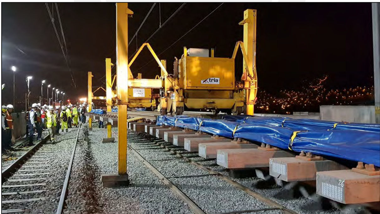
Fotografía: Montaje de aparejos y cambia vías mediante pórticos Fuente: Tría Ingeniería
