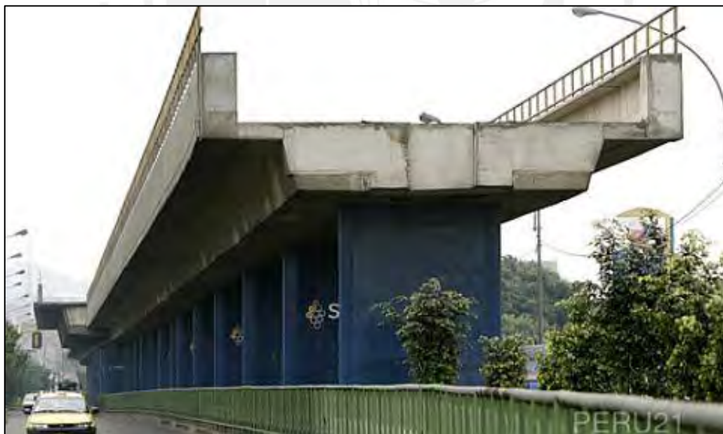
Figura: Infraestructura inconclusa abandonada Av. Tomas Marsano
