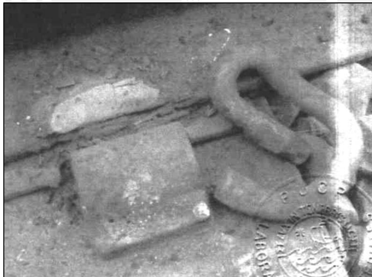
Figura 5.5: Riel y clip corroídos en tramo a rehabilitar
