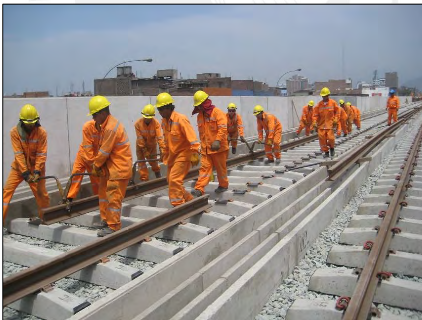
Fotografía: Acarreo de riel con tenazas (Viaducto elevado) Fuente: Informe mensual de Supervisión
