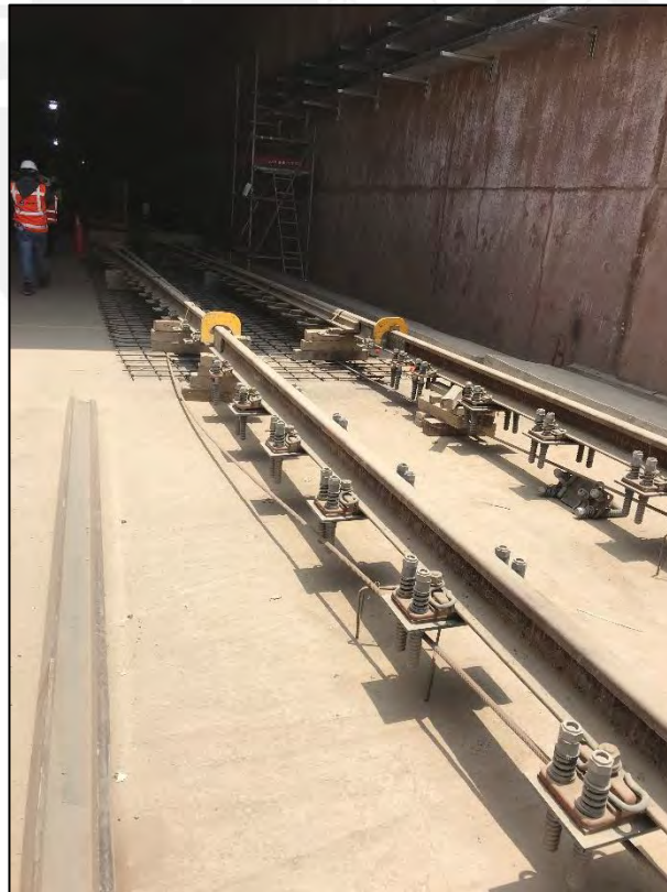
Fotografía: Acero para corrientes vagabundas y sujeciones Vossloh 336 SD (Zona previa a cambia vías)
