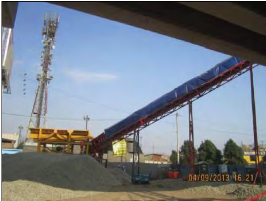
Fotografía: Transporte de balasto por Faja transportador (Viaducto Elevado) Fuente: Informe mensual de Supervisión
