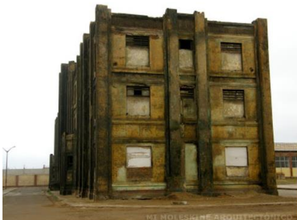
Figura 3-8: Estado de deterioro de un pabellón del Colegio Leoncio Prado
