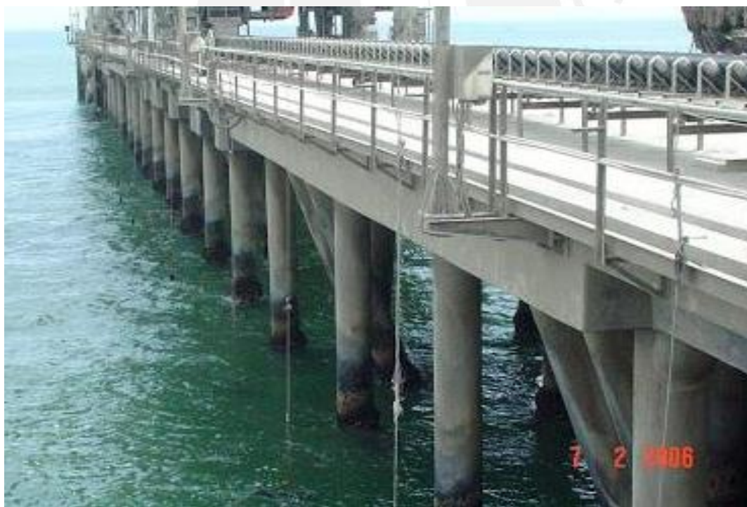
Figura 1-1: Inspección de Estructura de Muelle de Carga y Descarga en Lima, Perú- 2006. Exposición a ambiente de inmersión en agua de mar y a la agresividad atmosférica corrosiva marina.
