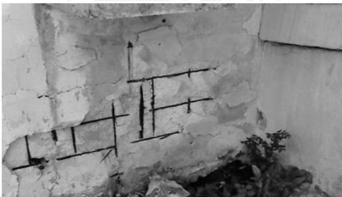
Figura 1-2: Muro de concreto reforzado dañado por efectos de corrosión
