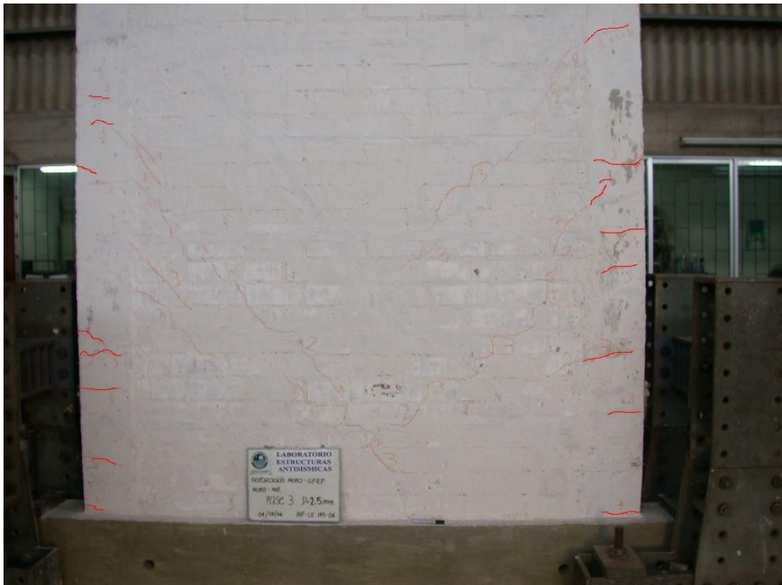
Fig. 10.9 Fase 3. Fisuras por flexión en el muro reparado.
