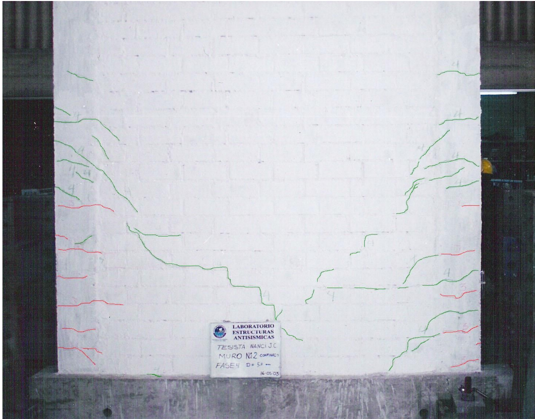
Fig. 7.1 Durante la Fase 4 ( D = 5.0\text{mm} ) se puede apreciar claramente el inicio de las grietas escalonadas en el muro, luego de haberse presentado las primeras fisuras por flexión en la fase 3 ( D = 2.5\text{mm} ).
