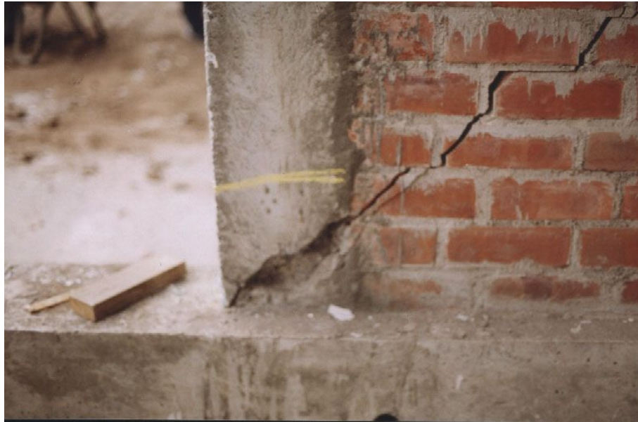
Fig. 8.3 Detalle de la trituración del concreto debida a la falla por corte del muro.
