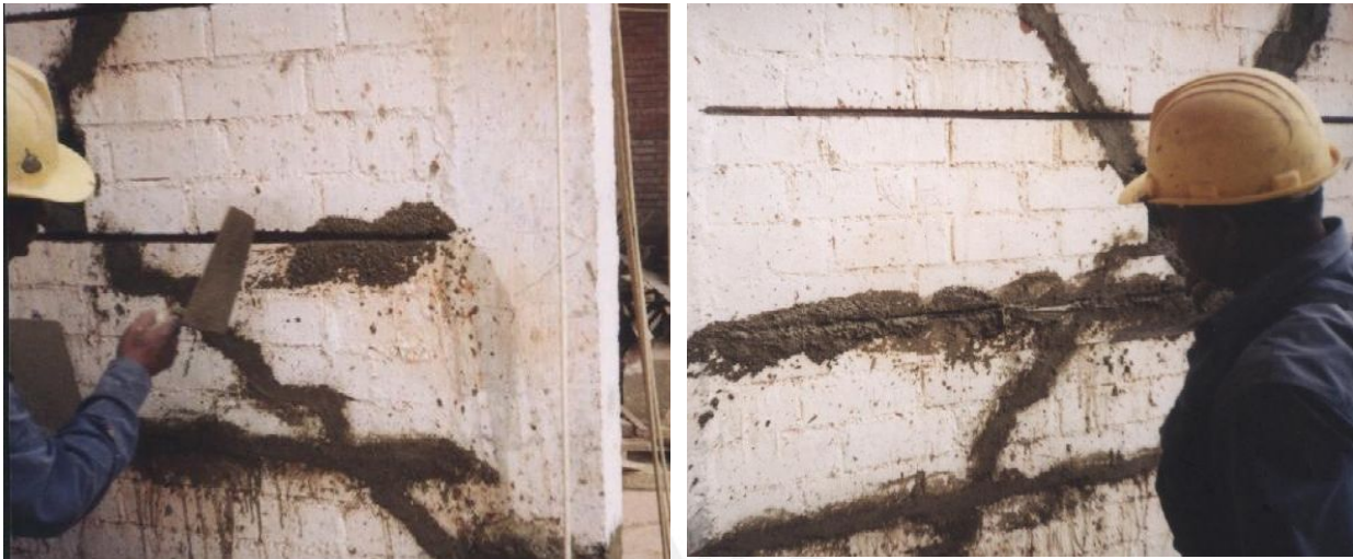
Fig. 8.15 Lanzamiento de mortero para crear la cama de asiento de la varilla (Izq.) e instalación de la varilla (Der.).
