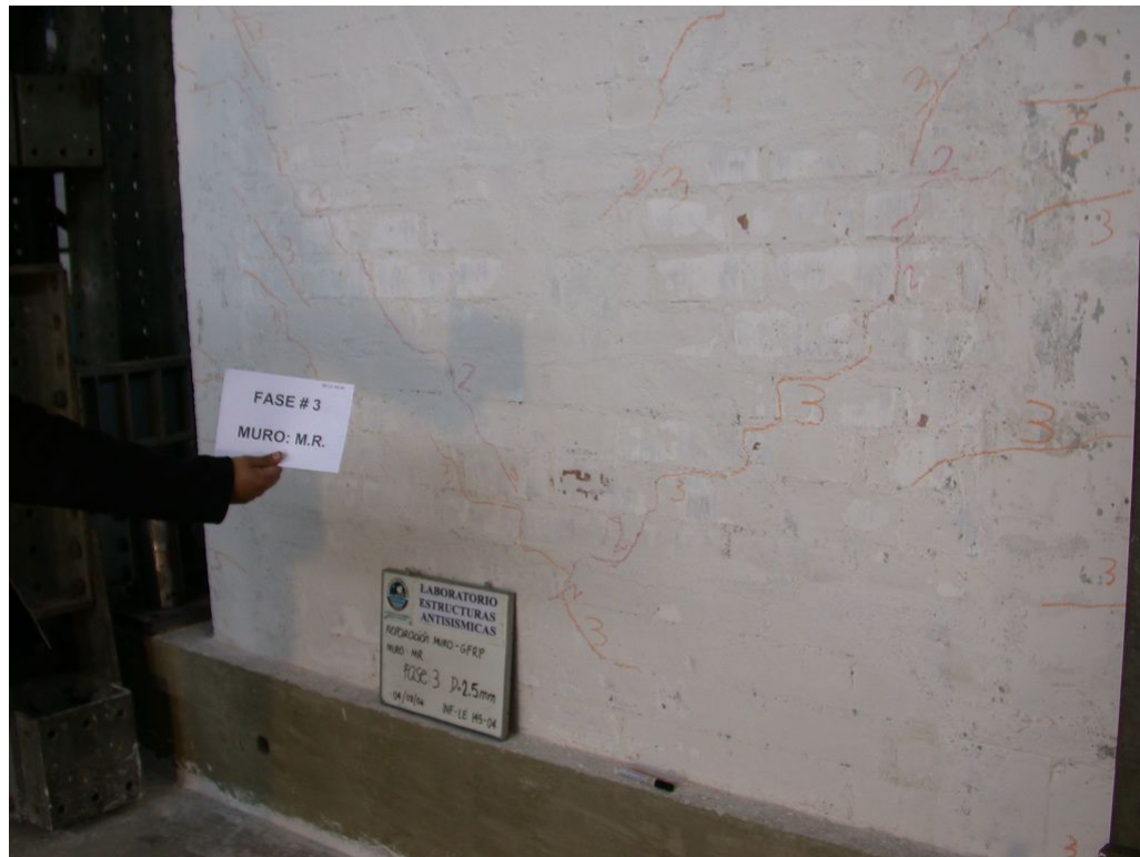
Fig. 10.1 Primeras fisuras por flexión, se pueden apreciar en ambas columnas (Fase 3, D = 2.5\text{mm} ).
