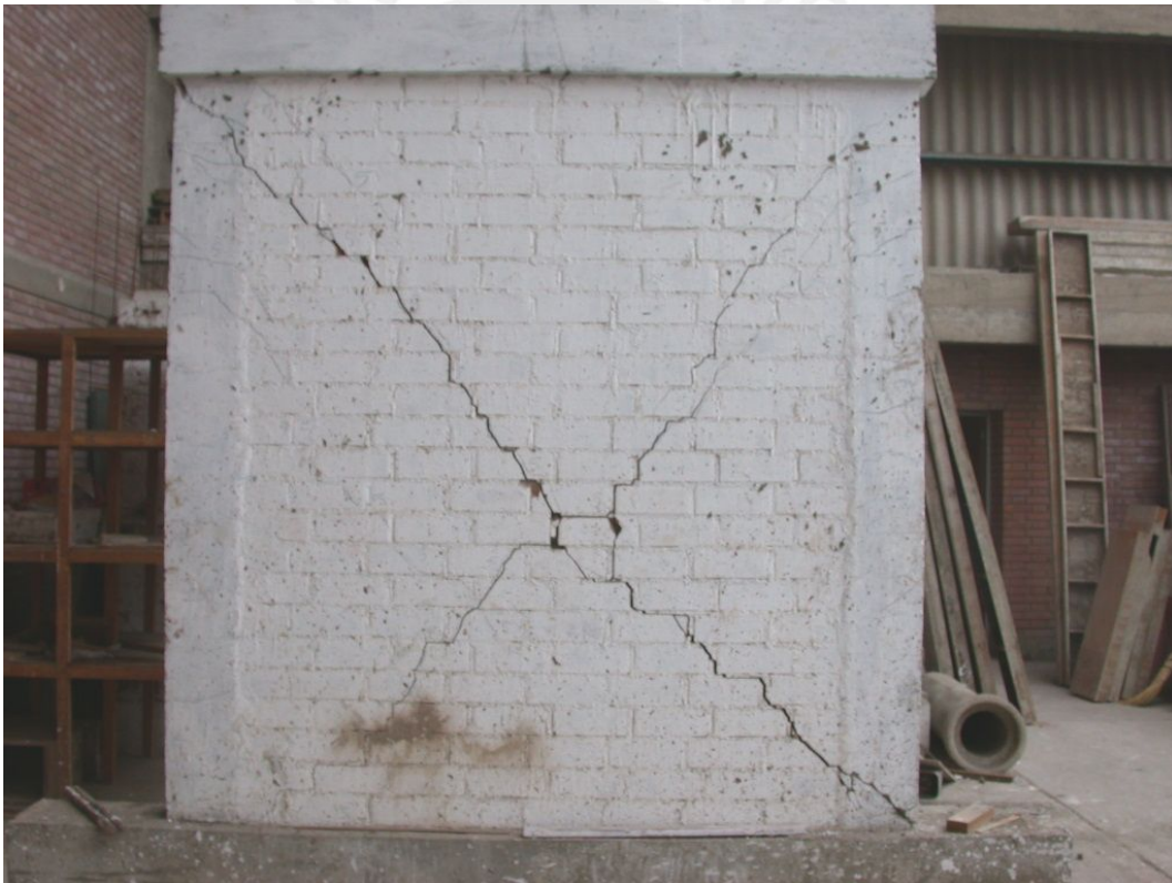
Fig. 8.1 Muro de albañilería original, antes de la reparación.
