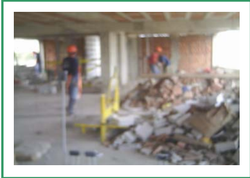
Falta de orden y limpieza en la obra.
