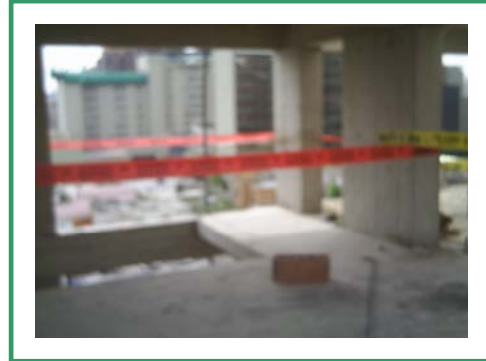
Falta de señalización al borde del edificio (Colocar baranda de protección).
