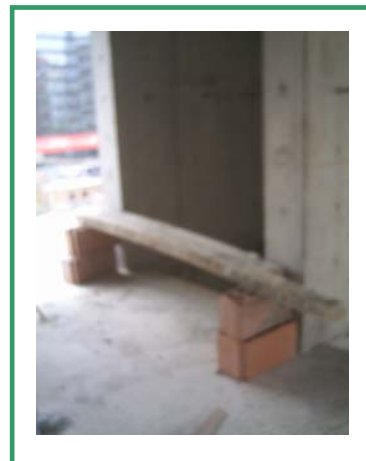
Falta de señalización en vano de ascensor.
