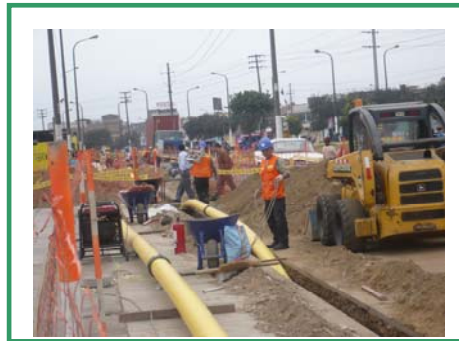
Uso de baranda y/ acceso en excavaciones
