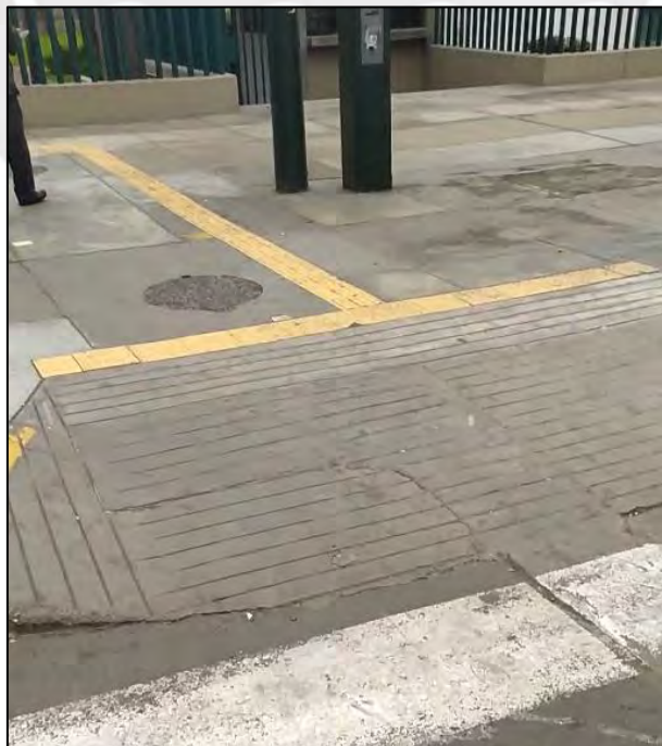
Figura 4.16 Tipo de implementación de pisos podotáctiles en cruces peatonales. Fuente: propia
