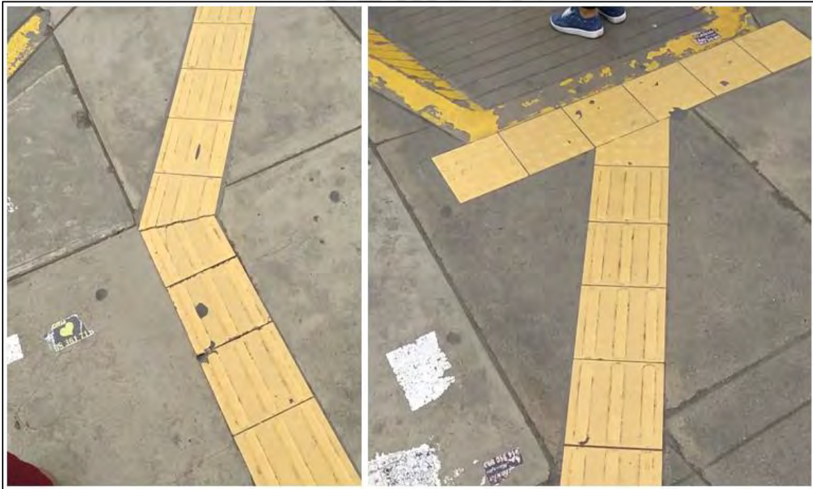
Figura 4.11 Cambio de dirección sin la utilización de baldosas preventivas. Fuente: Propia
