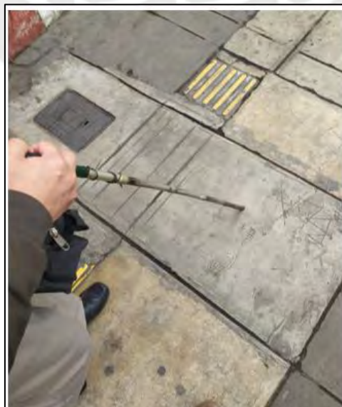
Figura 4.4 Presencia de discontinuidades en la red de pisos durante el desplazamiento del colaborador. Fuente: propia
