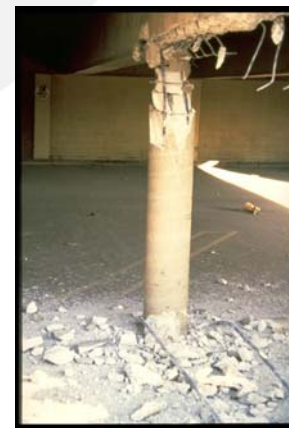
Figura 2.17 Concentración de rótulas en los extremos
