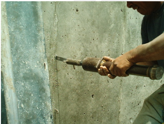
Foto 20: Excesivo retiro de concreto en los muros por tuberías.
