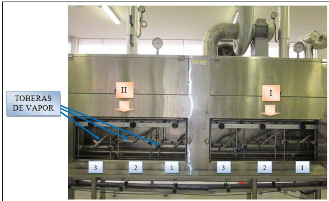
Figura 39: Regulación de Toberas de Vapor
