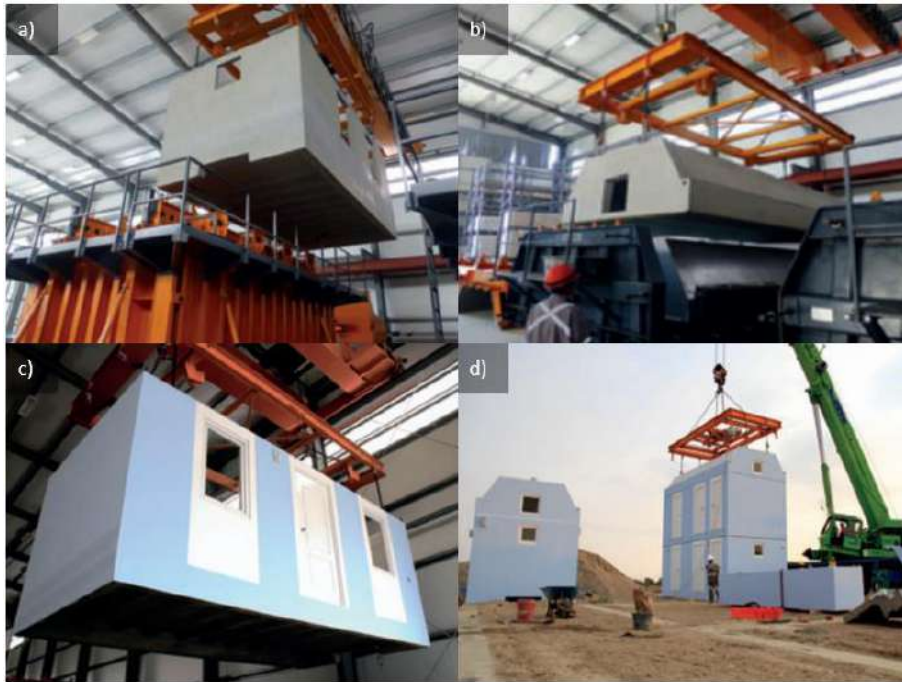
Figura 1.8. Construcción modular de viviendas. Transporte de a) módulo de ambiente y b) techo. c) Módulo terminado. d) Montaje final en obra.
