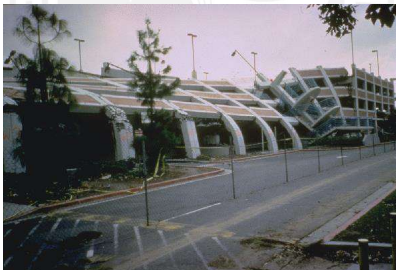
Figura 1.10. Colapso de un edificio de estacionamientos.
