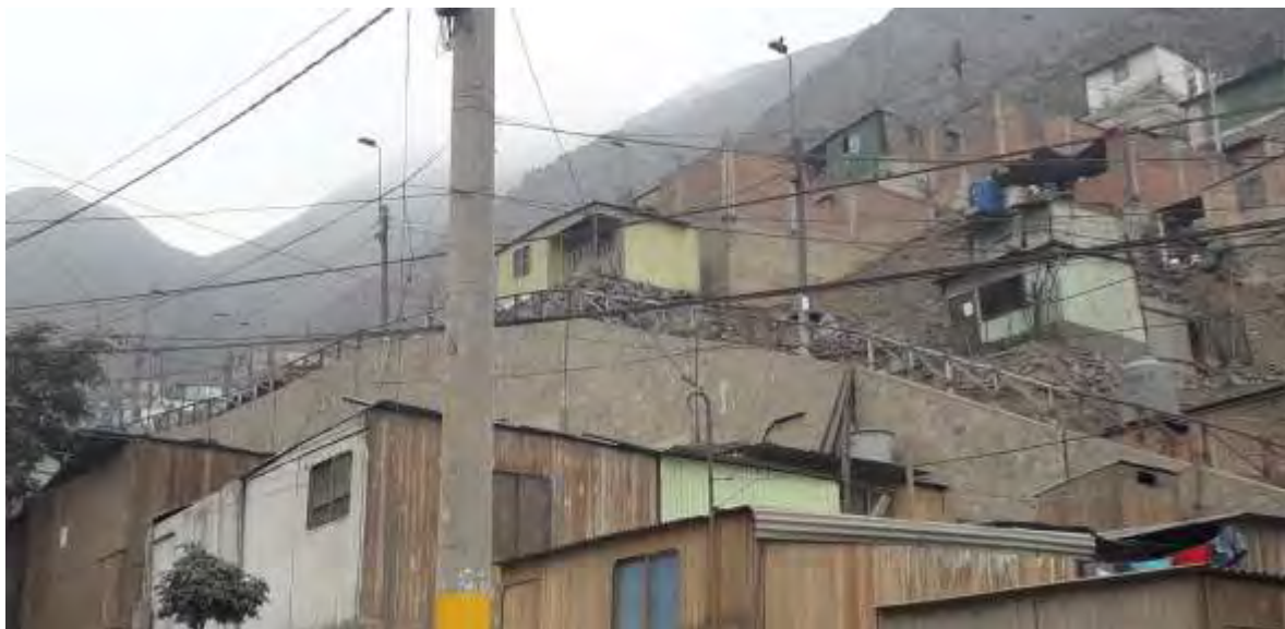
Ilustración 15. A pesar de la precariedad de las casa, la Asociación Paraíso cuenta con muros de contención. Imagen propia.
