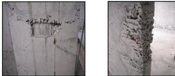
Figura 2.3: Cangrejeras y segregación del agregado (Herrera & Llosa, 2009)
