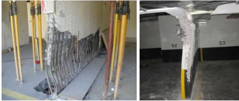
Figura 1.3: Fallas en edificios chilenos en el terremoto de 2010 (NEHRP, 2014)
