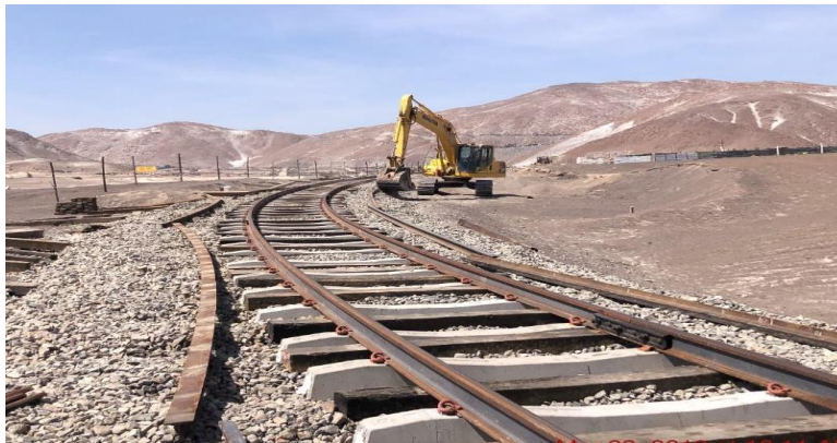
Figura 13. Fotografía de trabajos efectuados en vía, adaptado de “Informe del Área de ingeniería FTSA, 2018”.
