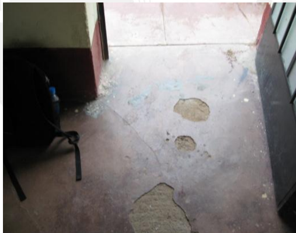
Figura 4.12. Goteras provocan erosión en los pisos del local escolar.
