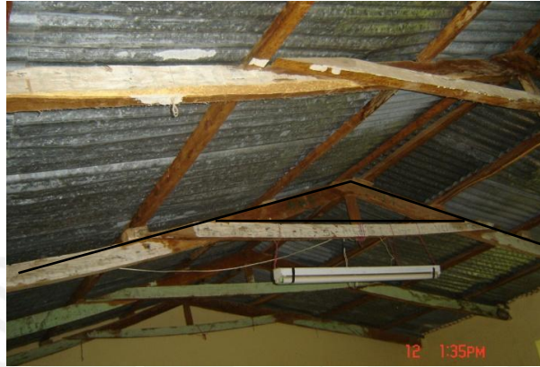
Figura 4.11. Fotografía del techo deteriorado del local escolar (Forma de par y nudillo)
