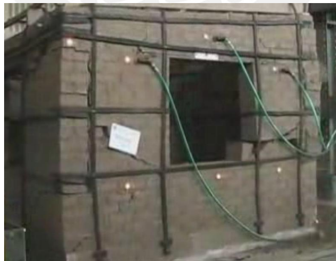
Figura 2.18. Ensayo dinámico de casa reforzada con tiras de llantas radiales usadas (Charleson, 2011)
