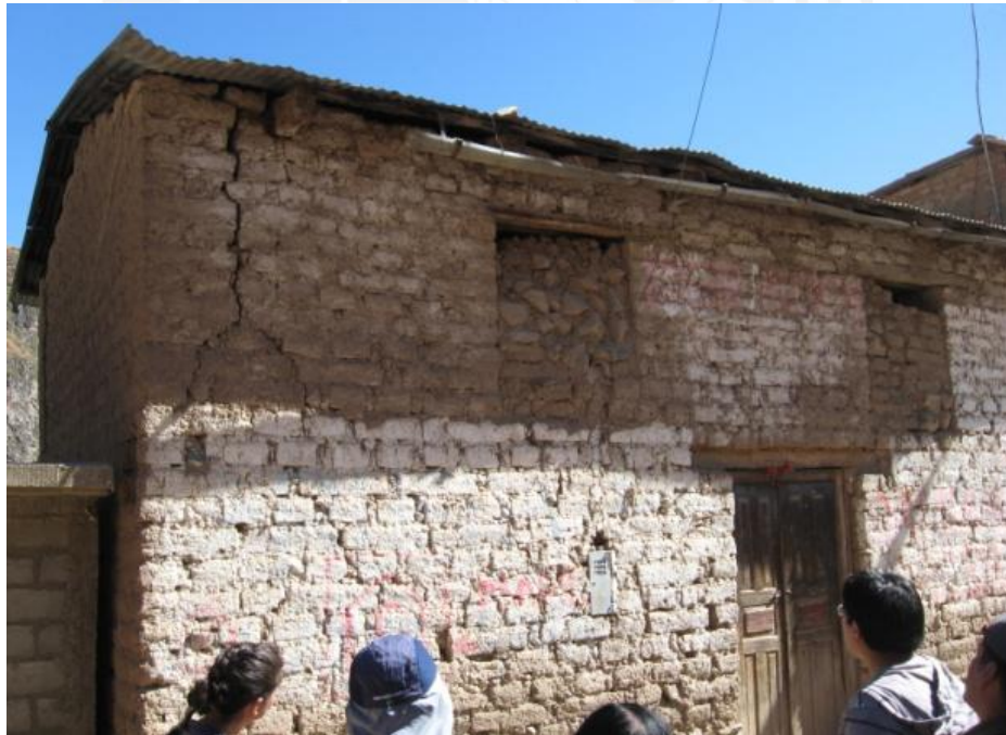
Figura 4.41. Formación de falla por volteo en una vivienda de Chocos
