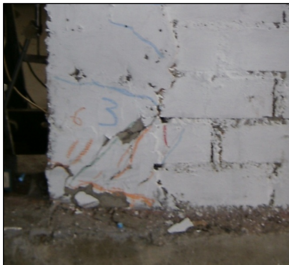
Fig. 7.7 Fisuras en el talón izquierdo del muro M1.
