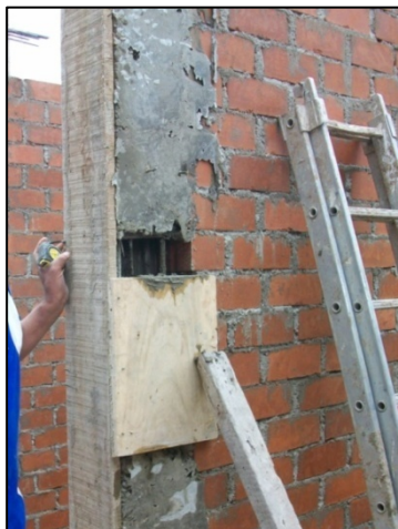
Fig. 5.14 Orificio en columna de muro M1.
