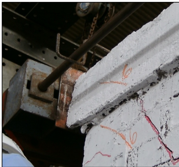
Fig. 7.8 Fisuras en la viga solera del muro M1.
