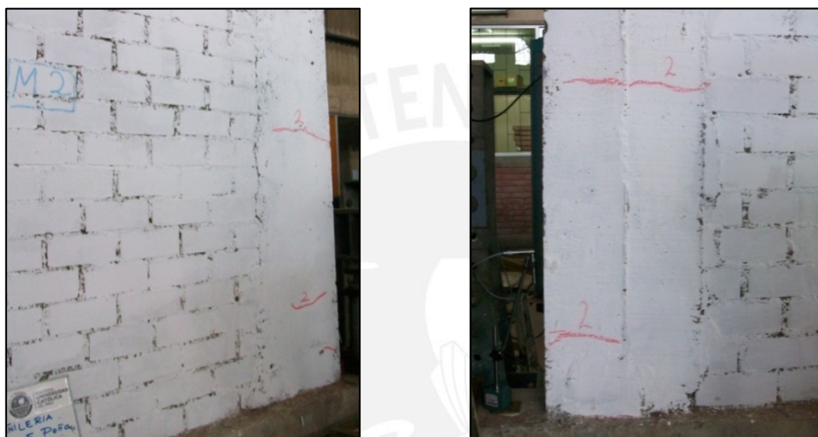
Fig. 7.12 Primeras fisuras producidas en las columnas durante la fase 2 del ensayo.
