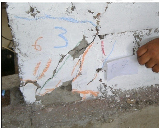
Fig. 7.9 Trituración en el talón izquierdo del Muro M1.
