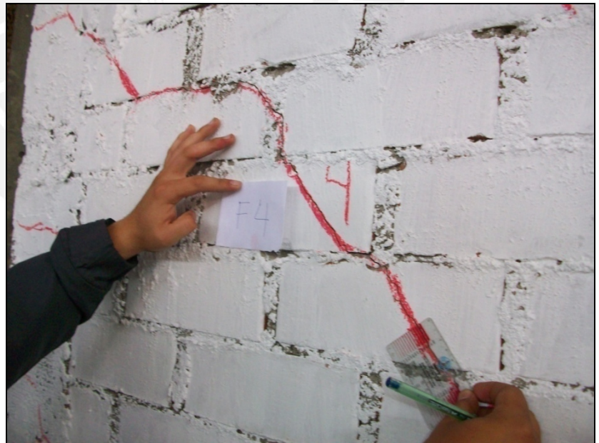
Fig. 7.4 Fisuras producidas en la fase 4, grosor de la fisura 1.25 mm.
