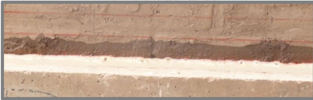
Fig. 47: Ascenso de agua por capilaridad a través del muro patrón.
