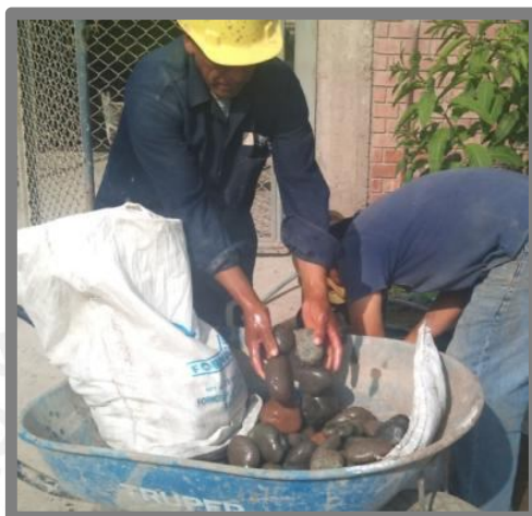
Fig. 3: Selección y lavado de piedras de 3" antes de aplicarlas en la mezcla del ciclópeo.
