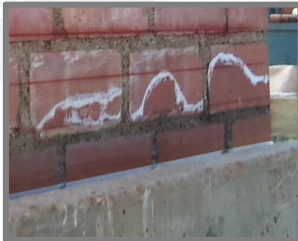
Fig. 55: Suciedad acumulada en la superficie del sobrecimiento de ladrillos inundado.
