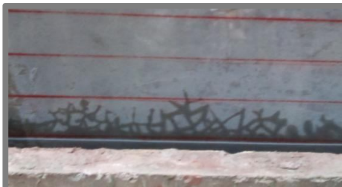
Fig. 50: Capilaridad en las fisuras del muro tarrajado MT
