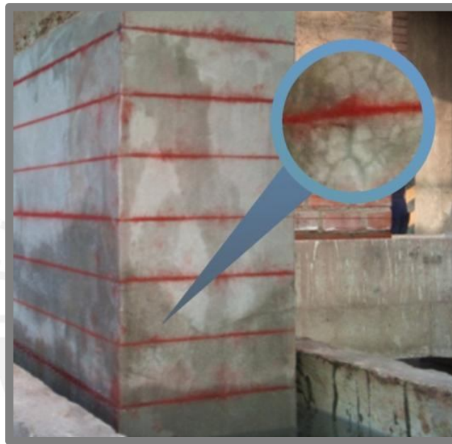
Fig. 53: Grietas en la superficie externa del tarrajeo pulido.
