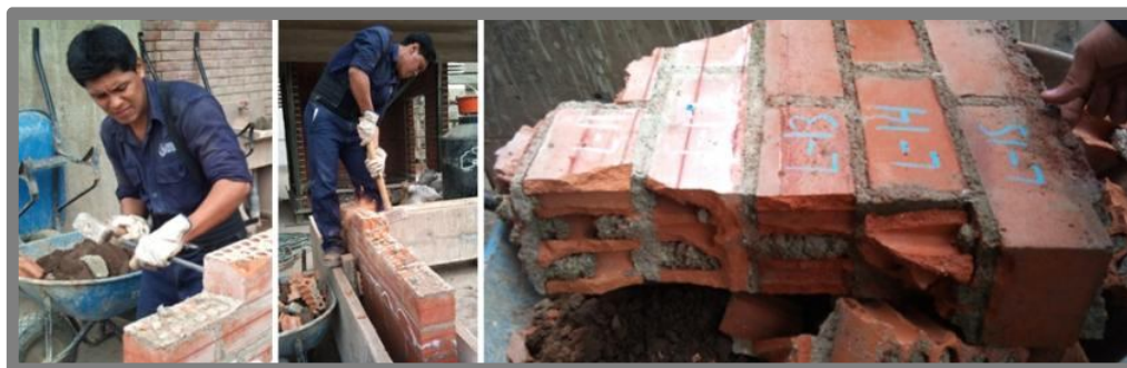
Fig. 39: Proceso de derrumbe del sobrecimiento de ladrillos.
