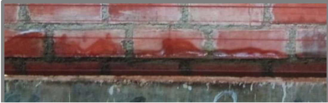
Fig. 54: Capilaridad discontinua en el sobrecimiento de ladrillos.
