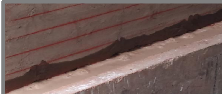
Fig. 48: Se aprecia un ascenso del agua no paralelo.
