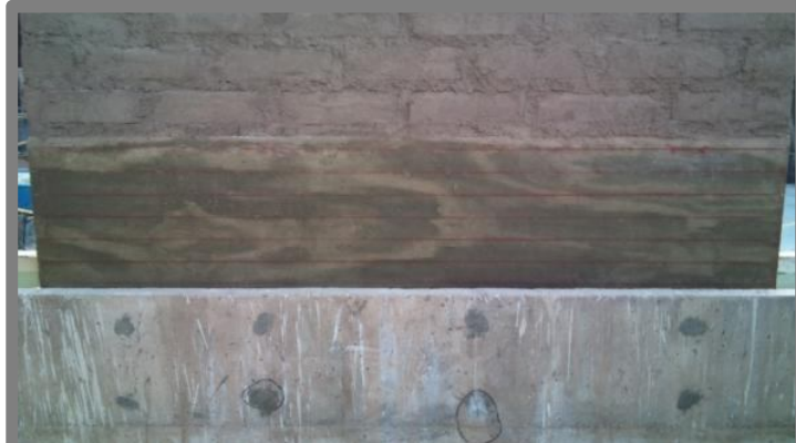
Fig. 57: Capilaridad en el muro de sobrecimiento ciclópeo después del periodo largo de inundación.
