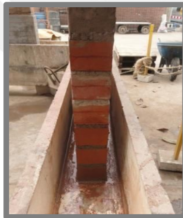
Fig. 52: Vista del muro con sobrecimiento de ladrillos después de la inundación.
