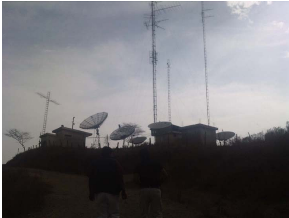
Figura 1-5: Cerro Ñañañique. Arreglo de torres y antenas
