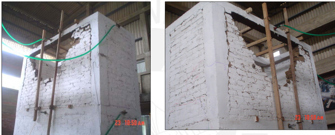
Fig. 6.11 Fase 4: Colapso de la mitad de muro de flexión del segundo piso
