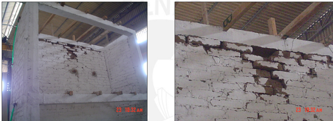
Fig. 6.9 Fase 3: Fallas en muro de flexión del segundo piso
