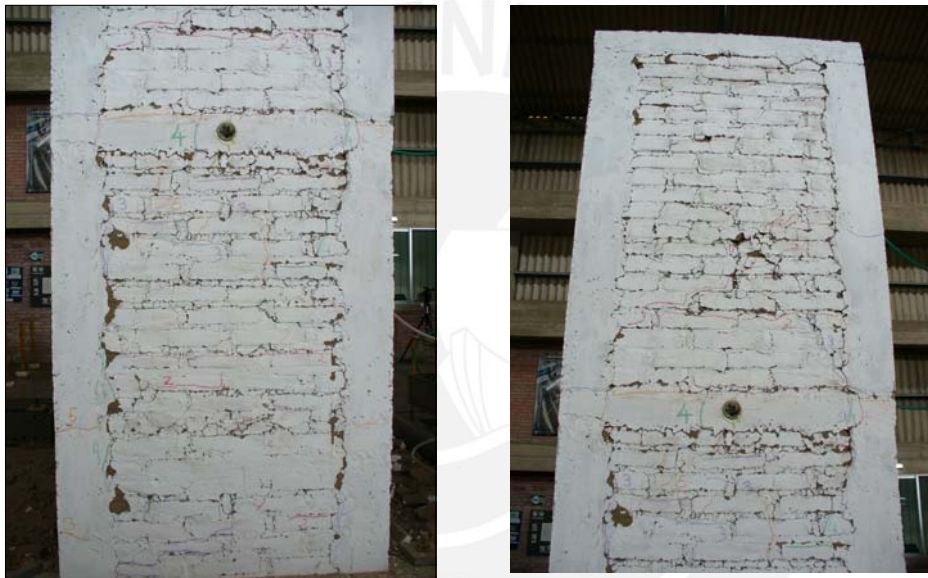
Fig. 6.13 Fase 5: Fisuras en el muro de corte de primer piso (izquierda) y segundo piso (derecha)
