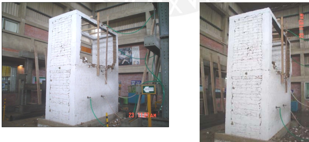
Fig. 6.14 Fase 5: Colapso total del muro de flexión del segundo piso
