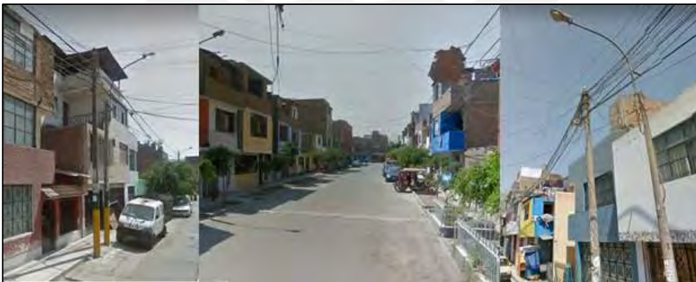
FIGURA 3 - 2: Despliegue aéreo de cables en calles de la Zona I de El Agustino [39]
