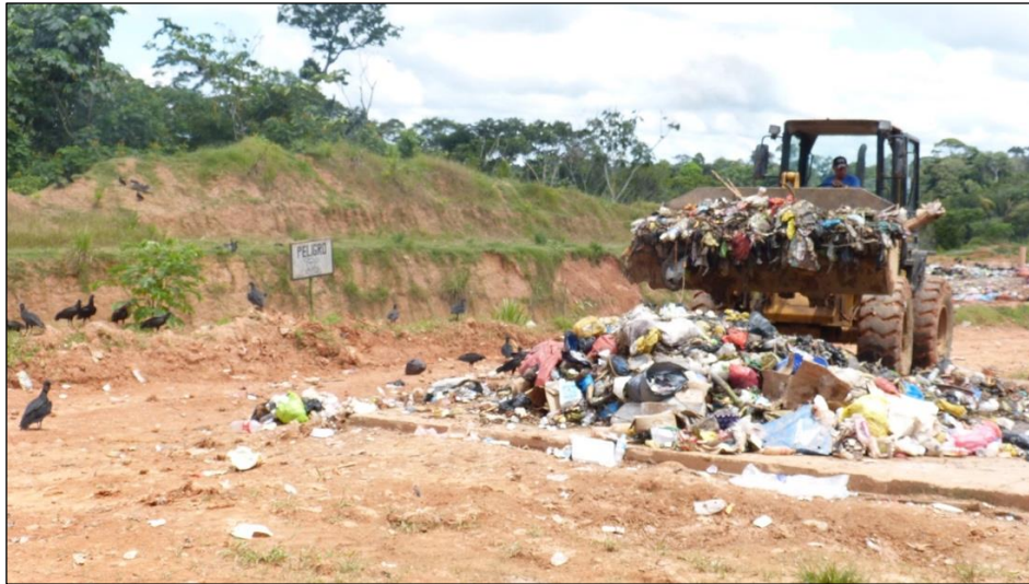
Figura 3.7: Cargador frontal realizando labores de relleno en el RS Nauta. Fuente: Archivo Personal
