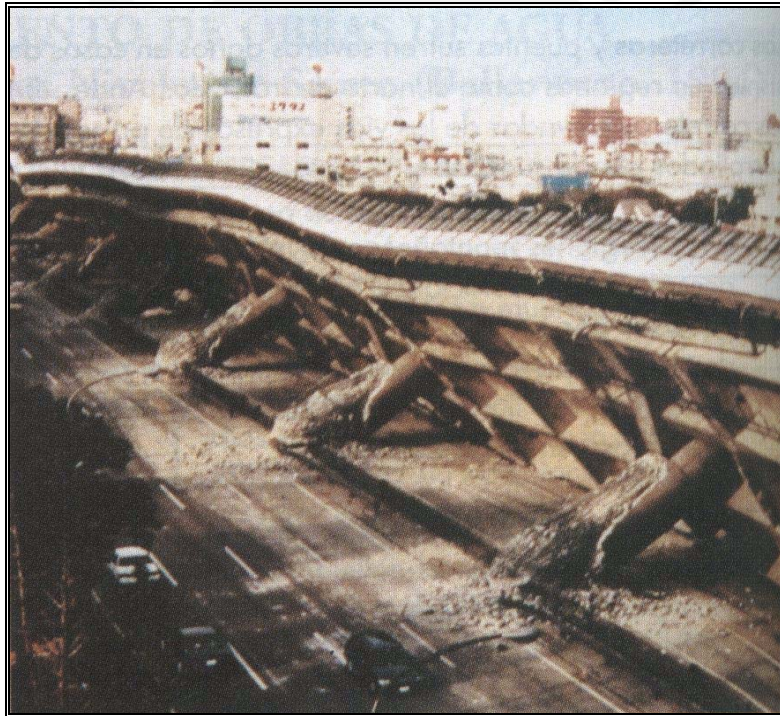
Figura N° 1.6. Colapso de puente. Terremoto de Kobe (17/01/1995).
