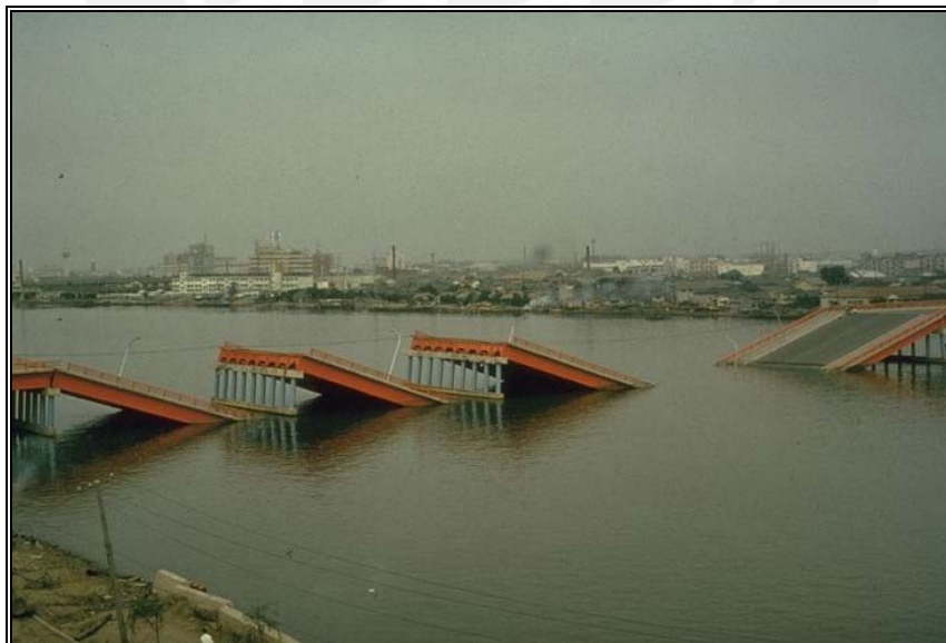
Figura N° 1.2. Colapso de puente, debido a grandes desplazamientos. Sismo de Niigata (16/06/1964).
