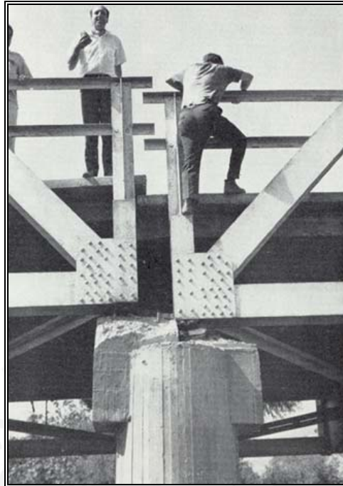
Figura N° 1.7. Daño en apoyo de puente. Puente Casma. Terremoto de Huaraz (31/05/1970).
