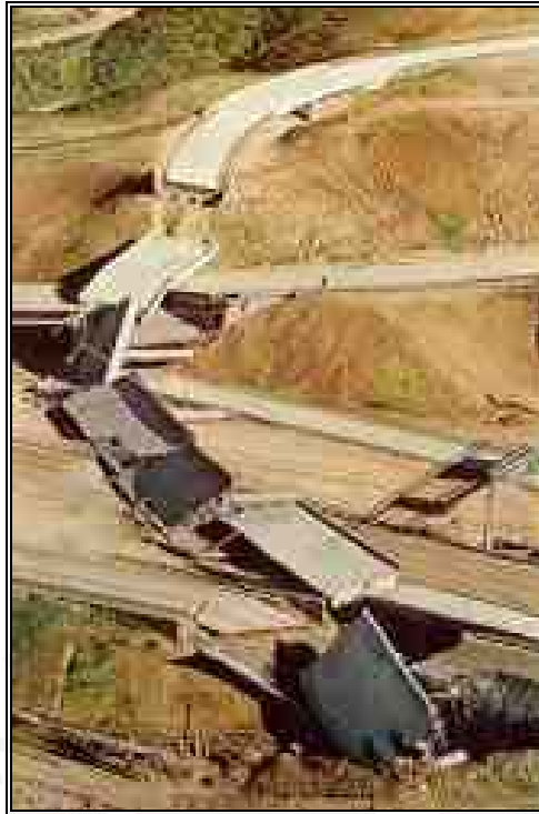
Figura N° 1.3. Colapso de puente. Sismo de San Fernando (09/02/1971).
