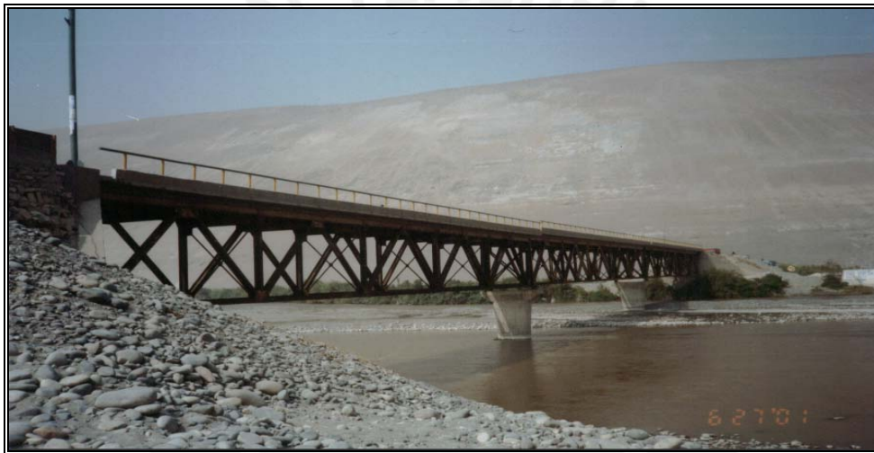
Figura N° 1.10. Ladeo lateral permanente de superestructura. Puente de la Punta de Bombón. Sismo de Atico (23/06/2001).
