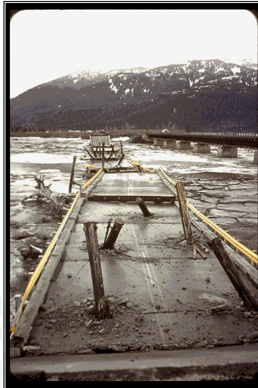
Figura N° 1.1. Colapso de puente en la localidad de Portage. Sismo de Alaska (27/03/1964).
