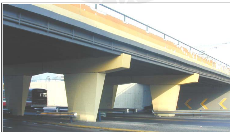
Figura N° 1.13. Pilares del Puente Andrés Reyes, sobre la Vía Expresa. Se observa una sección reducida en la base del pilar.
