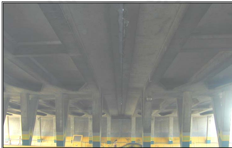
Figura N° 1.21. Puente Circunvalación, pareciera que no tiene una junta sísmica suficiente entre las dos superestructuras.
