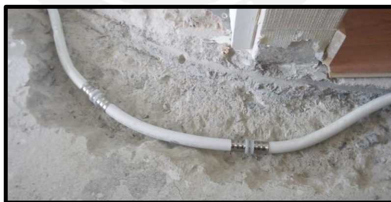
Figura 42 Tuberías obstruidas con cemento
