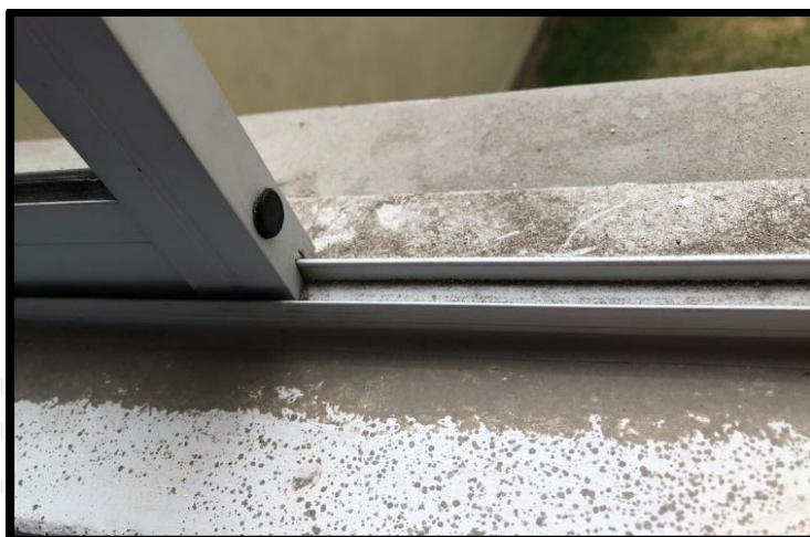
Figura 45 Riel de ventana muy corto con pestañas inseguras
