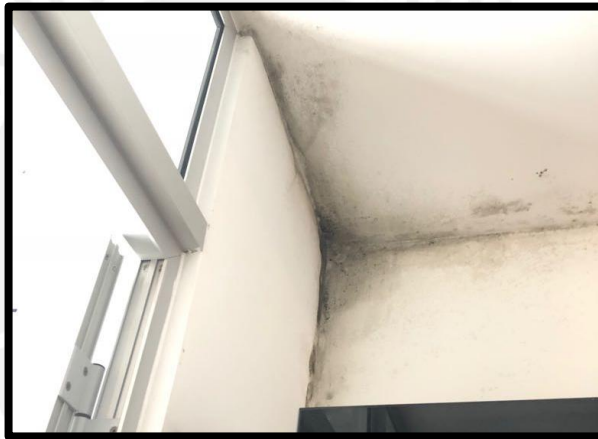
Figura 38 Hongos en pared y viga cercana a lavandería
