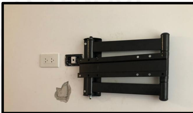
Figura 43 Pared de sala con fisura por instalación de soporte para televisor
