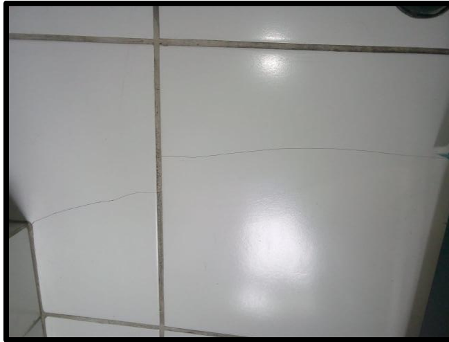
Figura 39 Cerámico de cocina fisurado
