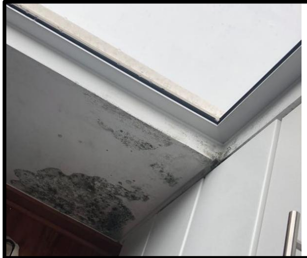
Figura 37 Humedad en pared al costado de la cajonería de closet
