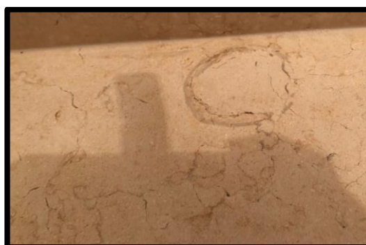
Figura 46 Mancha en tablero de mármol de baño principal
