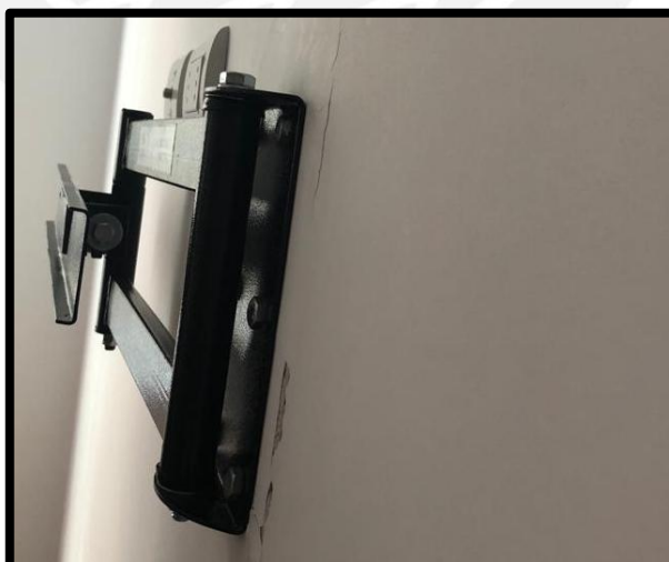
Figura 44 Pared fisurada del departamento vecino en zona de borde de soporte del televisor
