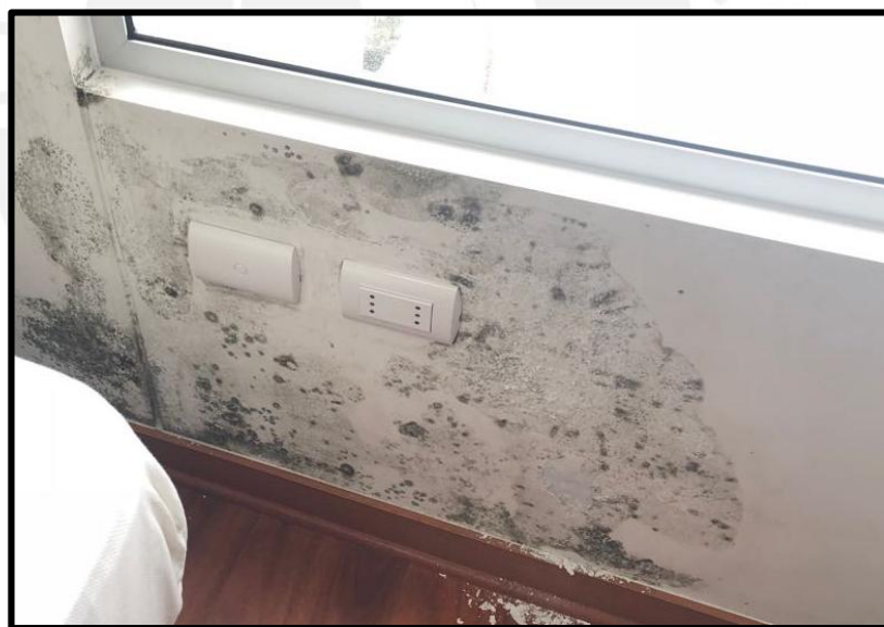
Figura 36 Humedad y hongos en paredes de un dormitorio principal
