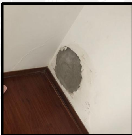
Figura 47 Pared con filtración en proceso de reparación
