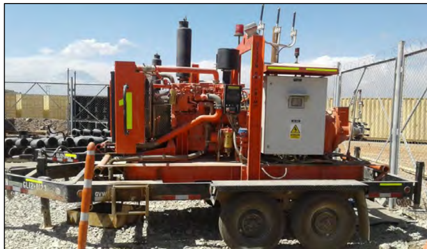
Figura 4.18 Moto-bomba en el almacén de Pit Dewatering
