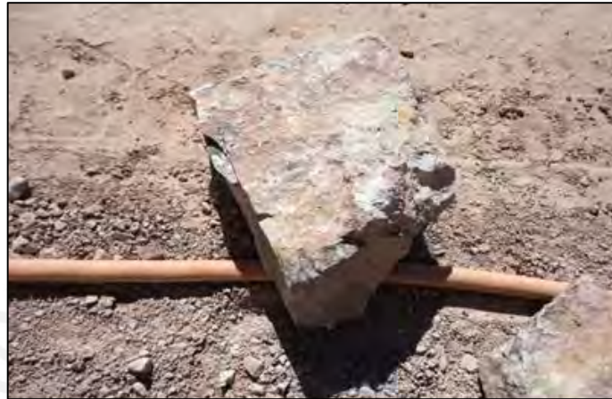
Figura 4.5 Cable eléctrico aplastado por una roca
