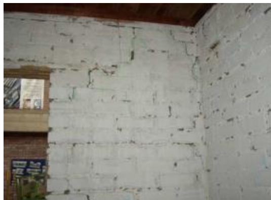
Figura 5.8. Fisuras en los muros de adobe del Módulo M1-SR, luego de la fase 5 (Tomado de Sánchez, 2006)
