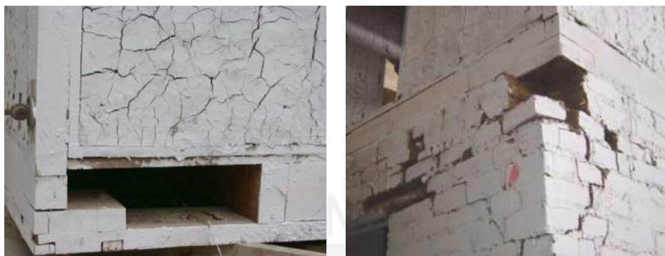
Figura 5.9. Deterioro en las esquinas del Módulo M2-CR, luego de la fase 5 (Tomado de Sánchez, 2006)
