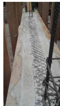
d) Ralladuras hechas a media fragua al día siguiente del vaciado
