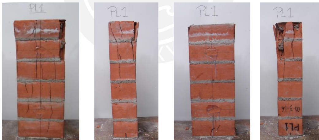
a) Fallas producidas en las caras de la pila 1. Primera imagen: se observan grietas a lo largo del eje. Cuarta foto: se observa aplastamiento en la base superior.
