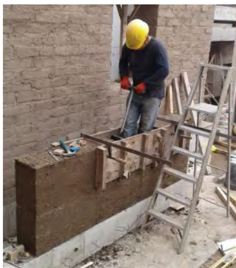
Figura 2.1. Compactación de tierra húmeda en la elaboración de un muro de tapial. Laboratorio de Estructuras Antisísmicas de la PUCP.
