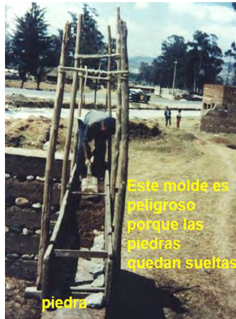
Figura 2.9. Encofrados no adecuados (San Bartolomé, 1989).
