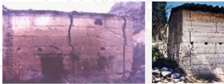
Figura 2.10. Muros con riesgo de volcamiento (San Bartolomé, 1989).
