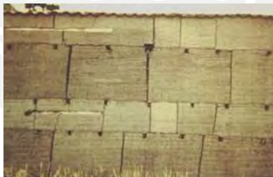
Figura 2.11. Grietas por contracción de secado. (San Bartolomé, 1989)
