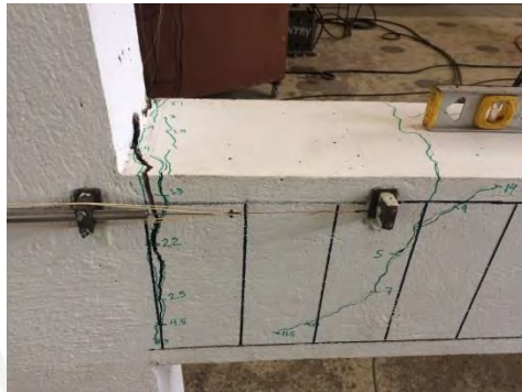
Fig. 54 – Grieta concentrada VA03
