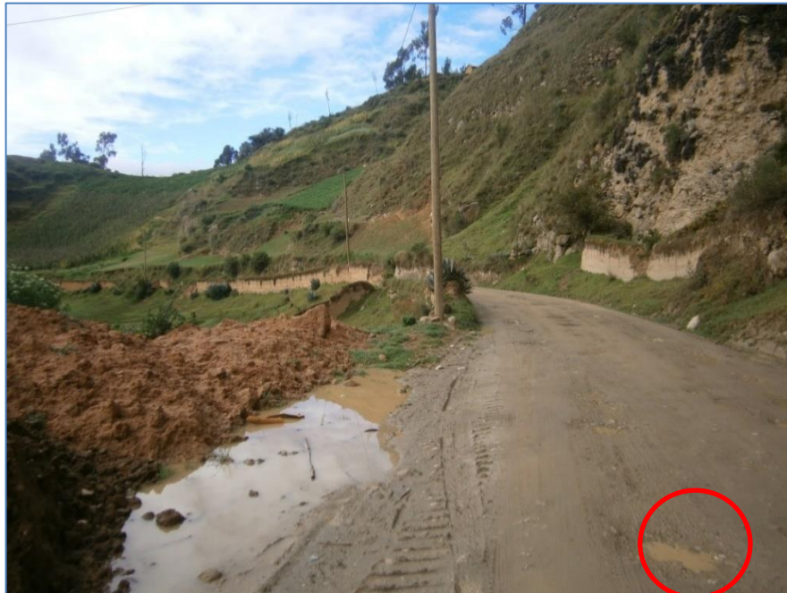
Fotografía N° 1: Estado actual de la rodadura del tramo 5 de la carretera
