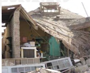
(b) Volteo muro con techo
