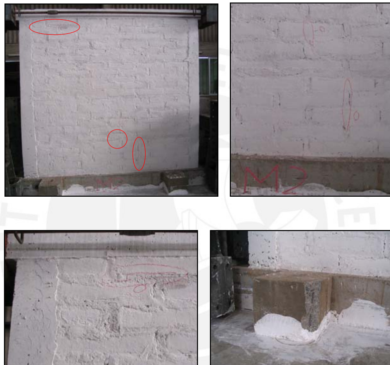
Fig. 4.3.2 Fisuras previas al ensayo del muro M2.
