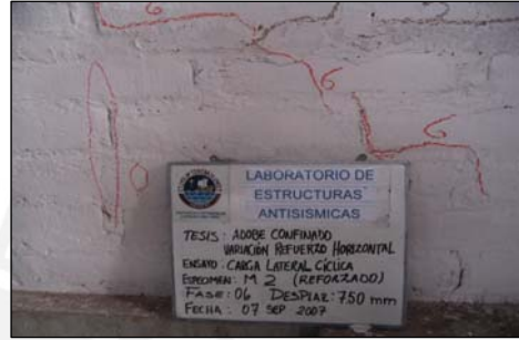
Fig.5.31. Fisura escalonada en el área inferior derecha del muro.
