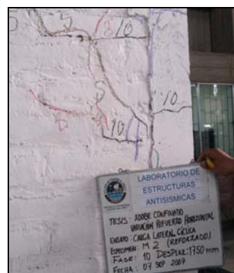
Fig.5.36. Fisura en la columna derecha, hilada 13.
