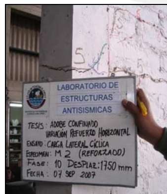
Fig.5.35. Fisuras en columna izquierda e=3\text{mm} .
