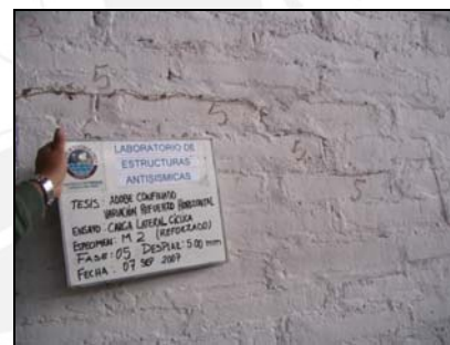
Fig.5.27. Fisura escalonada de izquierda-derecha.
