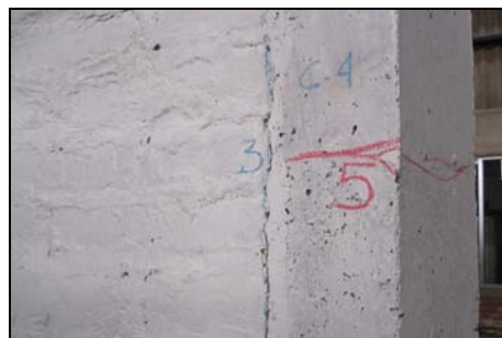
Fig.5.11. Fisuración de la columna derecha en hilada 13.
