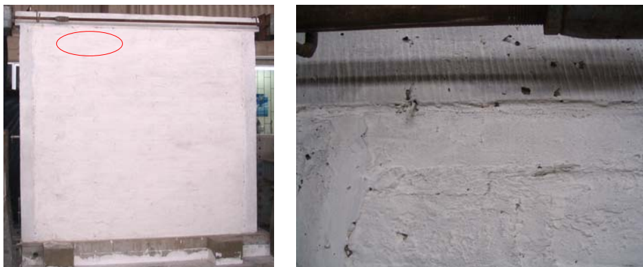
Fig. 4.12. Fisura previas al ensayo en el muro M1.
