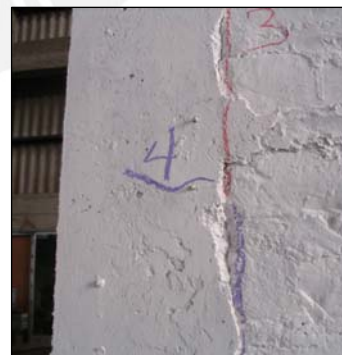
Fig.5.25. Fisuración de la columna izquierda.
