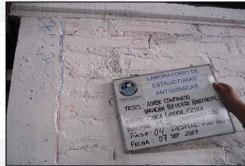
Fig.5.23. Fisuración escalonada del área superior izquierda del muro.
