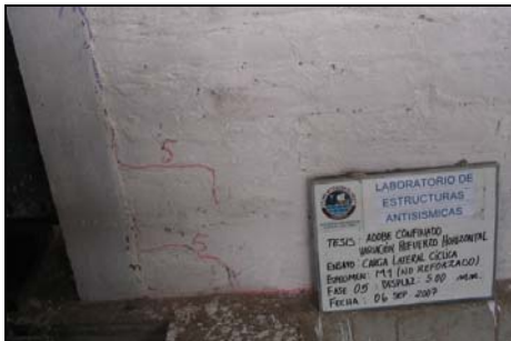
Fig.5.7. Fisura en conexión muro-columna izquierda que enmarca al 100% el muro.
