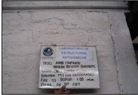
Foto 5.6a. Primera fisura, área superior derecha del muro.
