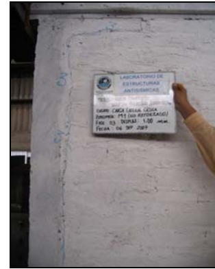
Foto 5.6b. Fisuración de la conexión muro-columna izquierda.
