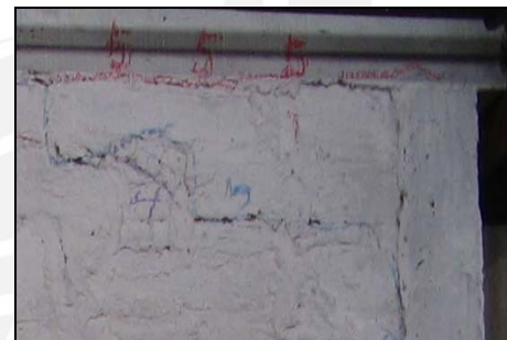
Fig. 5.10. Fisuración unión muro-viga solera y conexión columna derecha.
