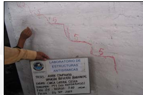
Fig. 5.8. Inicio de la fisura diagonal escalonada.
