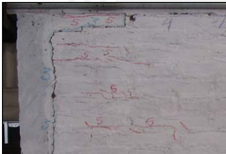
Fig 5.9. Fisuración por las juntas horizontales.
