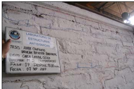
Fig.5.32. Fisura en la junta horizontal de la hilada 21.
