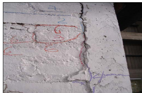
Fig.5.33. Grieta en la conexión muro-columna, se cierra al llegar al refuerzo horizontal.
