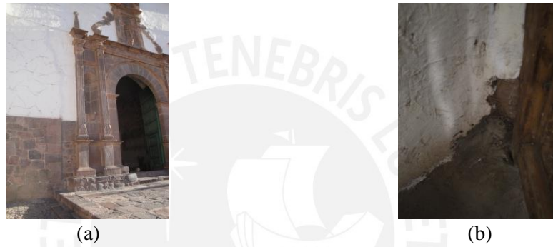
Figura 4.17: Demostración de algunas patologías presentes en la Iglesia San Juan Bautista (a) Fachada Principal; (b) Interior
