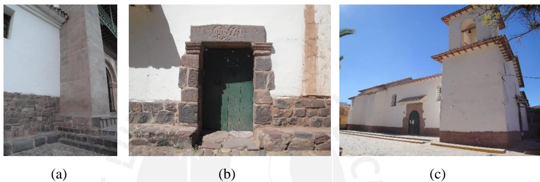
Figura 3.4: Demostración de la separación de los materiales; (a) Iglesia Andahuaylillas; (b) Iglesia Canincunca; (c) Iglesia Lucre
