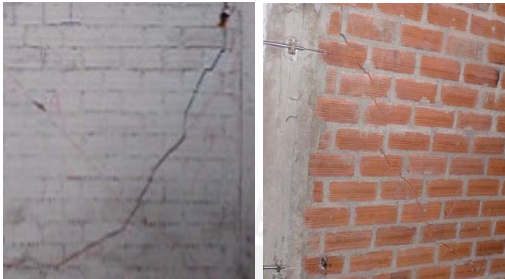
Figura 8.19. Grieta diagonal de 6mm para carga negativa en M1.
