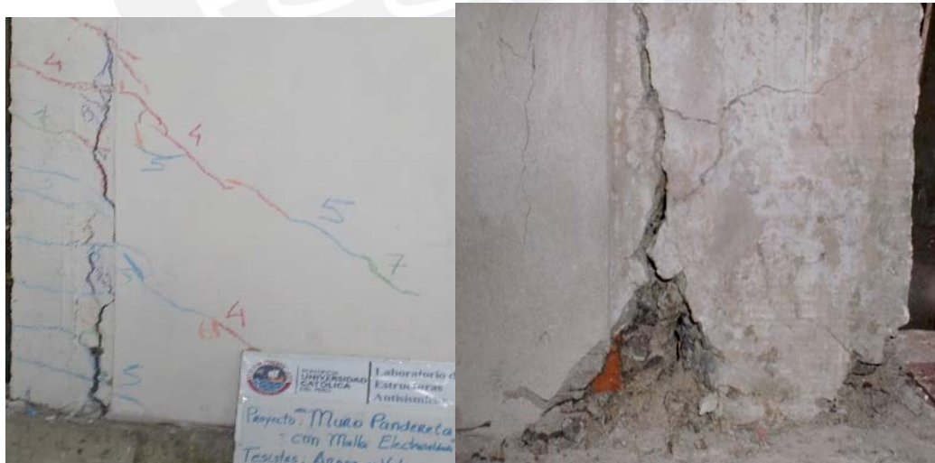
Figura 8.26. Trituración del concreto en columna derecha, en ambas caras de M2.
