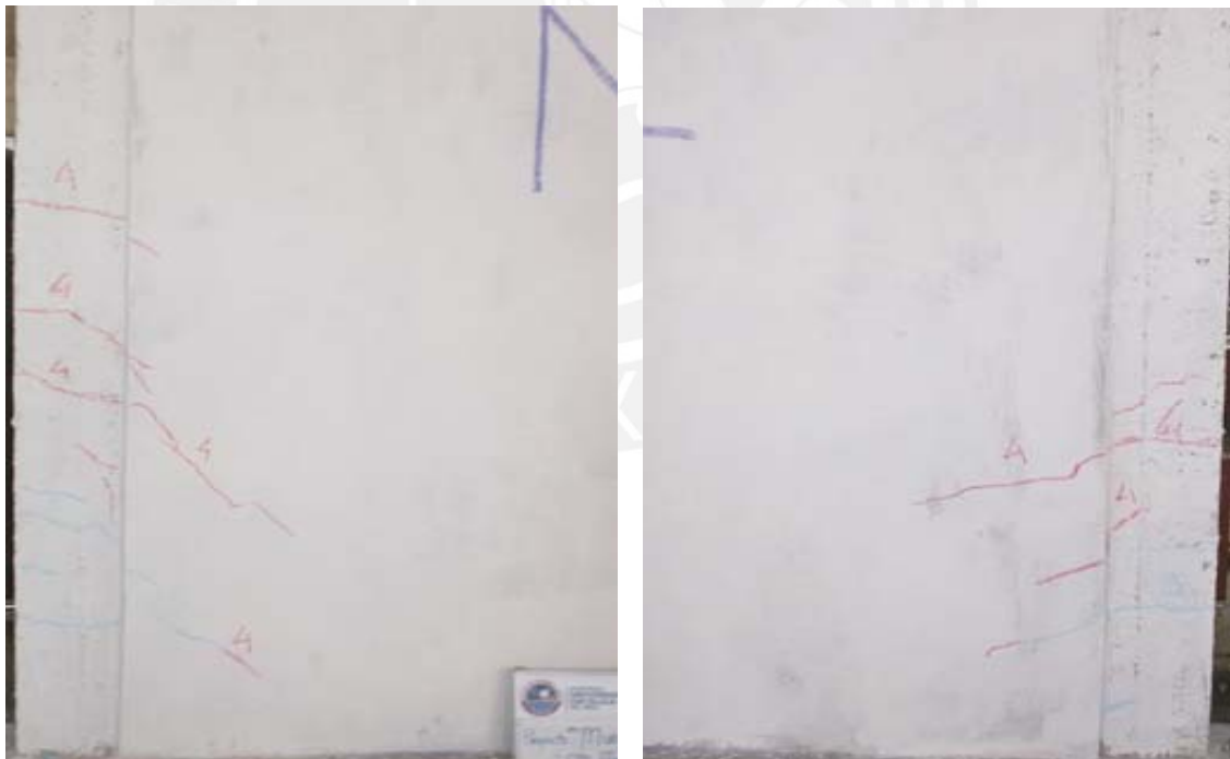
Figura 8.10. Fisuras horizontales en zona intermedia de columnas y diagonales en M2
