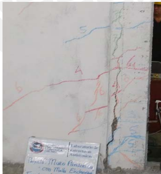
Figura 8.20. Grieta vertical en la conexión albañilería-columna derecha en M2.
