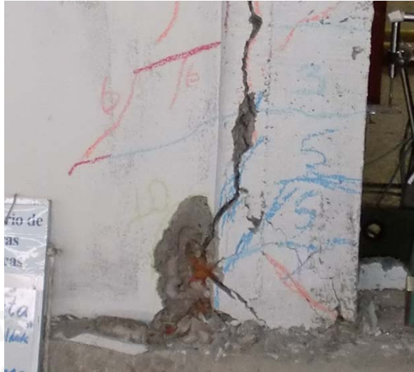
Figura 8.29. Desprendimiento del tarrajeo en M2.
