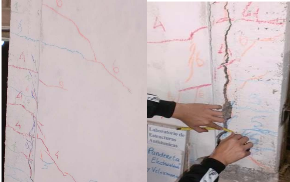
Figura 8.23. Grietas verticales en ambas columnas de M2.
