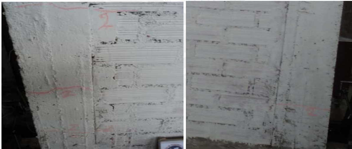
Figura 8.4. Fisuras de Tracción por Flexión en Columnas de M1
