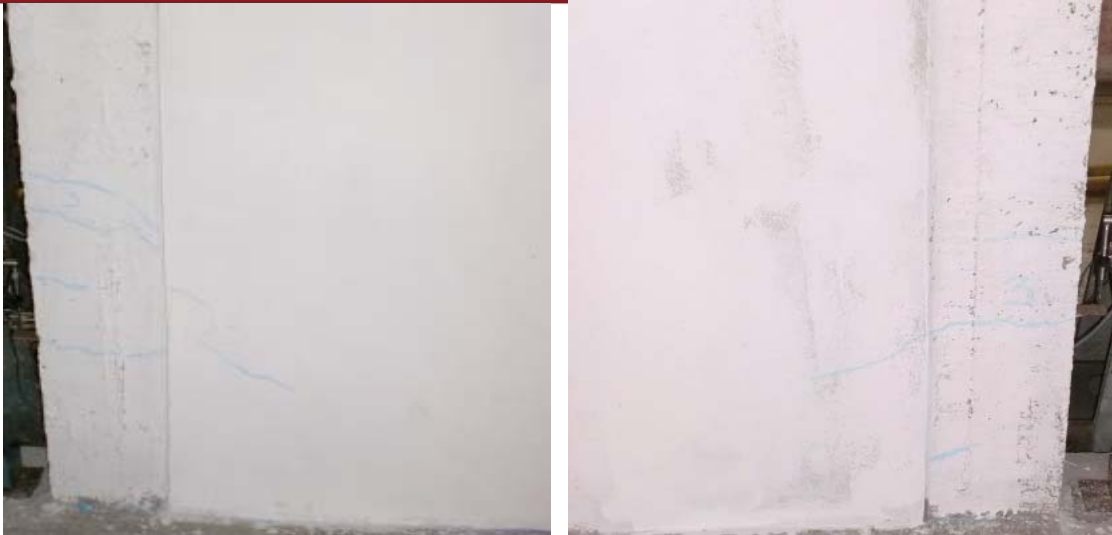
Figura 8.7. Fisuras en columnas y pequeñas fisuras diagonales en la albañilería de M2
