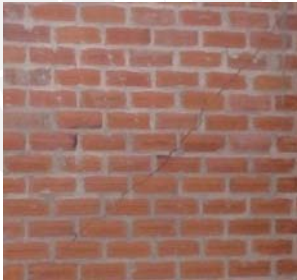
Figura 8.16. Grieta diagonal en la otra cara de M1.
