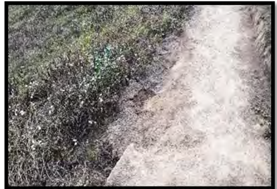
Camino con desprendimiento
