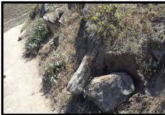
Derrumbe de piedras
