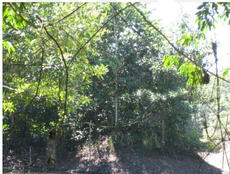
Figura 30: Crecimiento de vegetación natural sobre pilas abandonadas.
