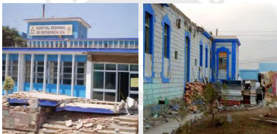
Fig. 2.7: a) Hospital Regional de Ica. b) Daños en los tabiques
