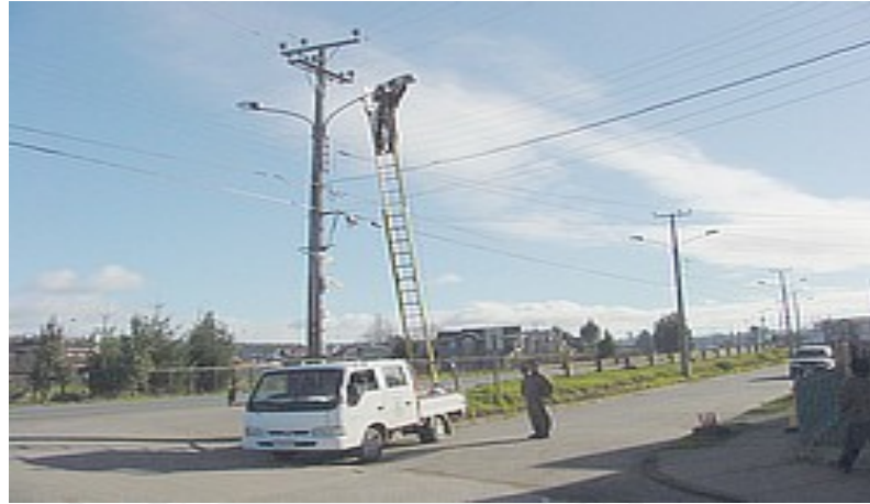
Gráfico 12: Mantenimiento del servicio de Alumbrado Público
