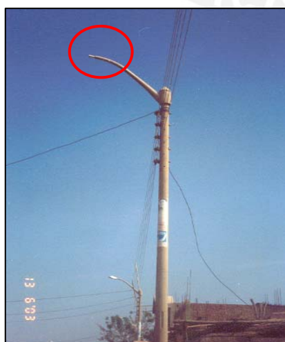
DT3: Falta de lámpara
