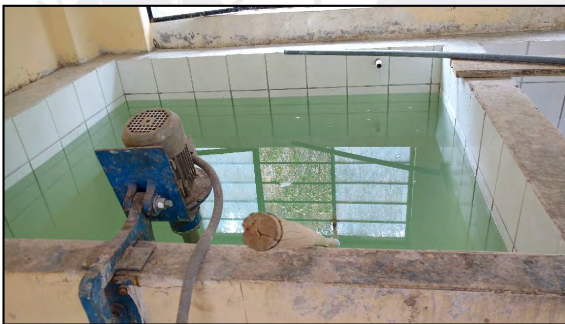
Figura 23. Pozo de mezcla del coagulante.
