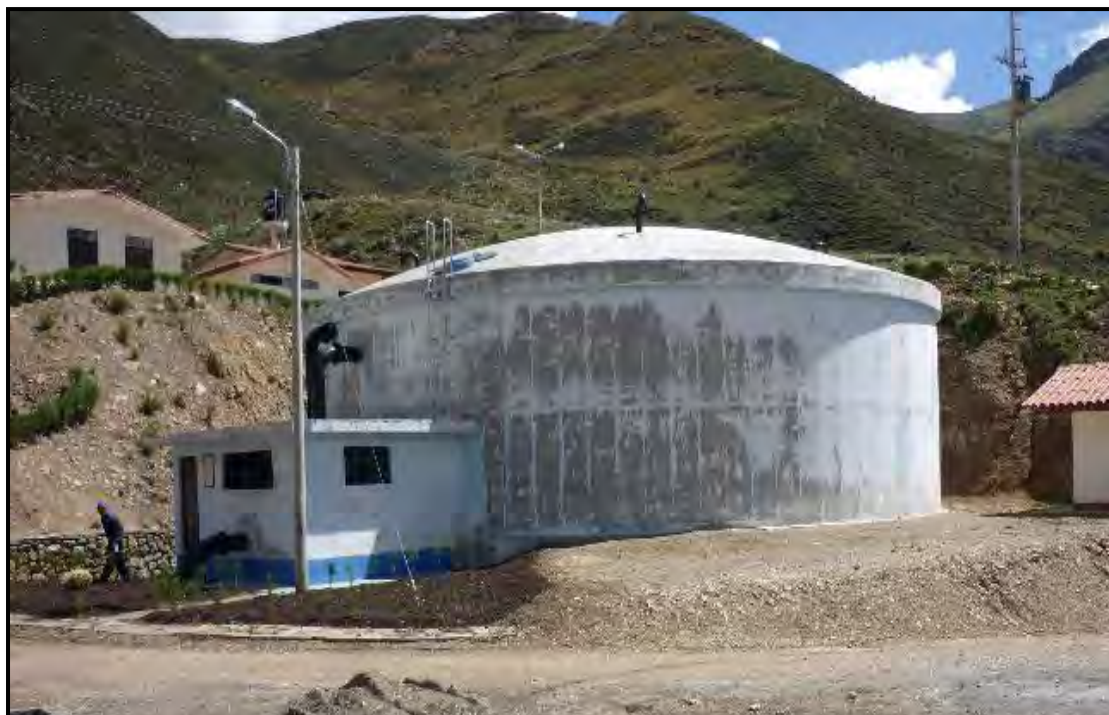
Figura 28. Reservorio de 1,000 m 3 .
