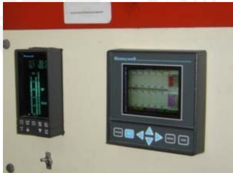
Figura 1.4 Vista del Controlador Indicador y el Registrador de la Planta de Presión.
