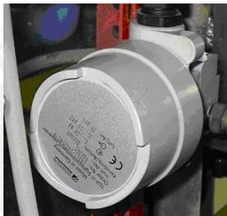
Figura 1.5 Vista del Convertidor Electro-neumático de la Planta de Presión.
