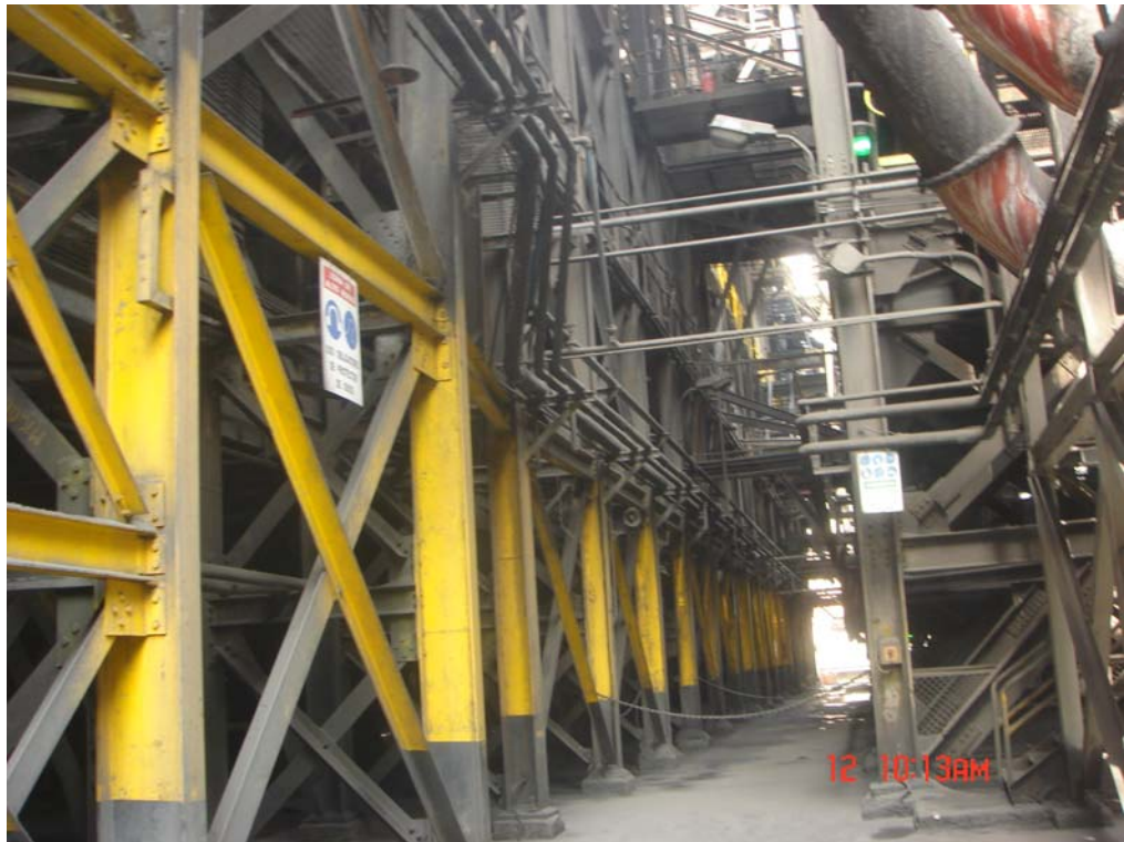
Foto 2.2 B: Estructuras que soportan a todos los equipos de la maquina principal 2051
