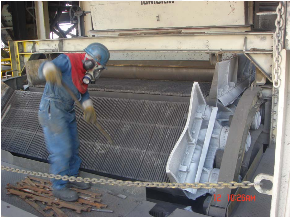
Foto 7.1: La linealidad de los carros sinter, después de reparados ya no tiene problemas, hasta el momento no hay deformaciones térmicas, su verificación es mucho más rápida.
