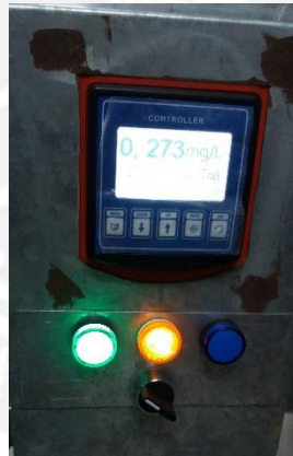
Figura 4.19: Sistema en estado de clorinación.
