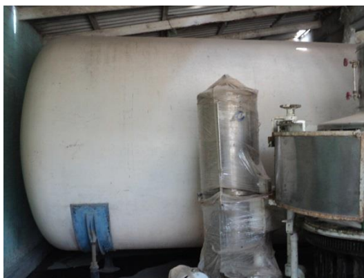
Figura 3.2: Fotografía del tanque pulmón.
