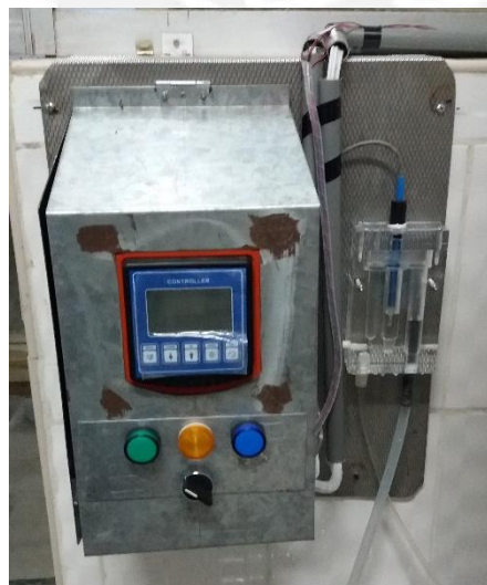
Figura 4.4: Fotografía del frente del tablero.
