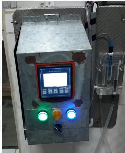
Figura 4.20: Sistema señalizando la falta de solución de cloro.
