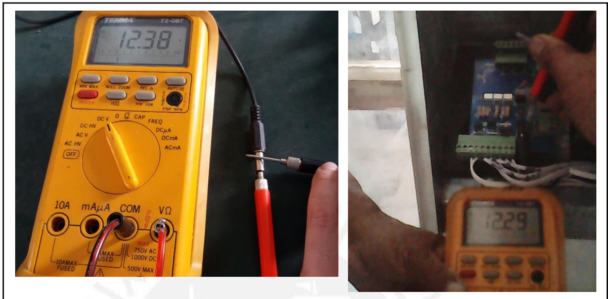
Figura 4.17: Pruebas de la fuente de alimentación, sin carga y con carga.
