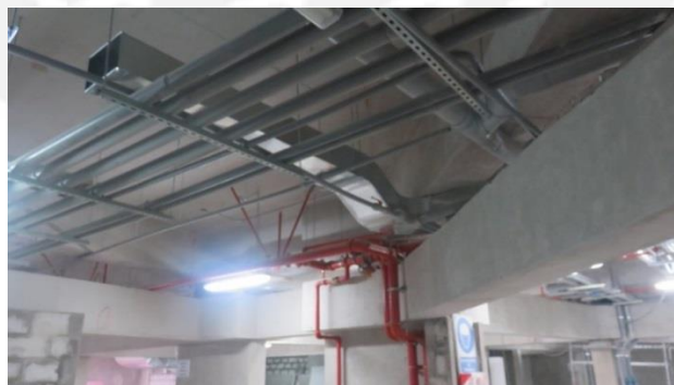
Ilustración 78 Ducto instalado. Fuente: Propia.
