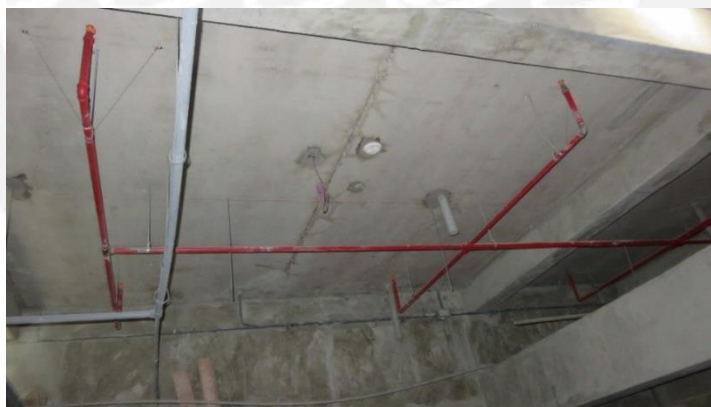
Ilustración 81 Situación en campo para elementos coordinados a instalar. Fuente: Propia.
