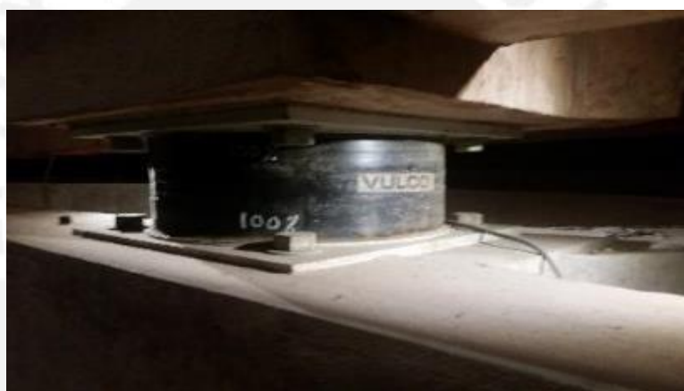
Figura 2.2. Aislador elastomérico en la Biblioteca de Ingeniería – PUCP
