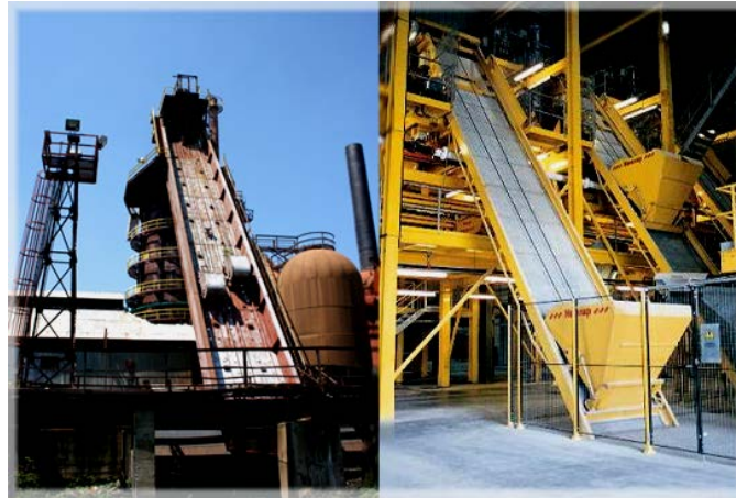
Figura 3.1. Aplicaciones industriales del Skip Hoist
